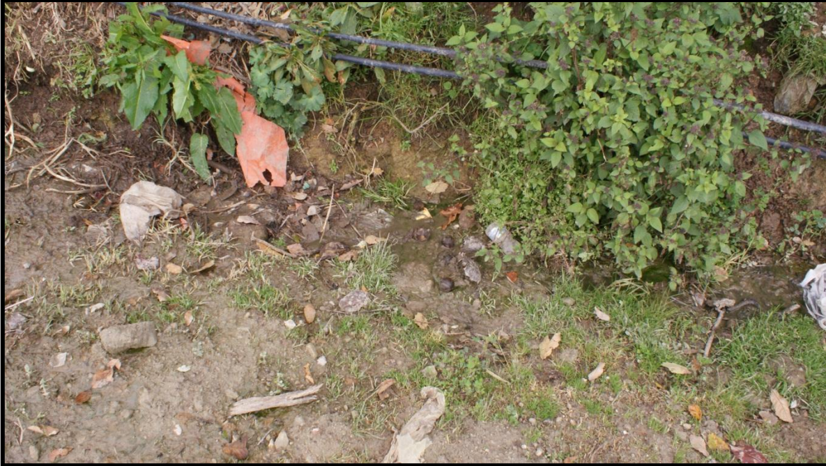
Imagen 8. Vista de una zanja donde corre agua de desecho domestico, se puede apreciar las tuberías de agua potable improvisadas por los pobladores.
