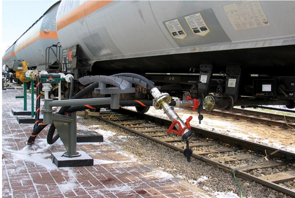
Figura. 2.4 Carga de carros tanques trasportadores de Gas LP.
