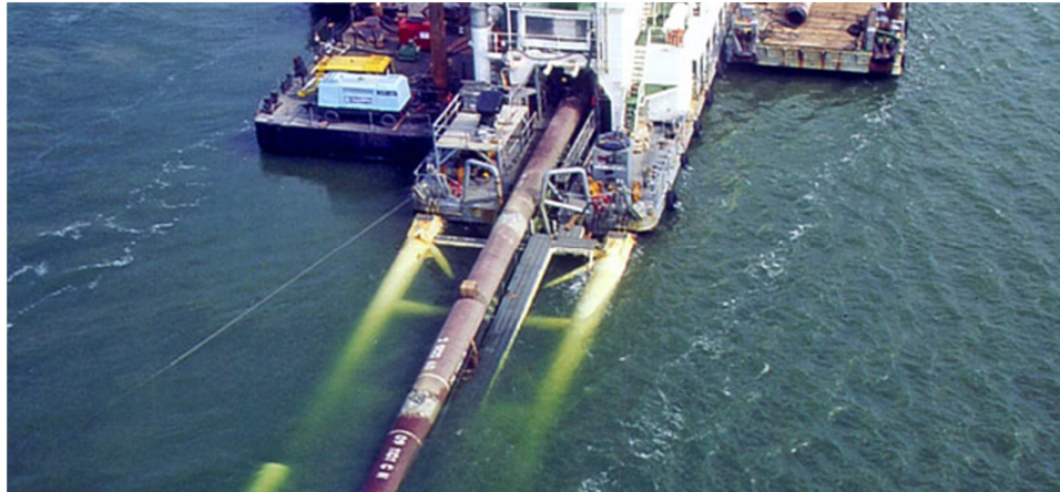
Figura. 3.14 Los 620 km de largo del gasoducto de 40" se extiende desde la plataforma 16/11-E a las instalaciones en Alemania. La presión de diseño de la tubería es de 159.07 kg/cm 2 . La ruta atraviesa zonas de aguas poco profundas cerca de la costa, con la llegada a tierra en la costa noroeste de Alemania del Mar de Wadden.
