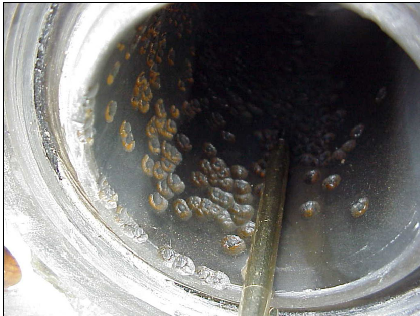
Figura 3.23 Esta corrosión, ocasionada por \text{CO}_2 , se denomina “pitting” y se presenta en todos los componentes tubulares, porta-estranguladores, conexiones superficiales, etc.
