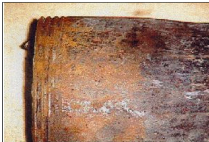
Figura 3.22 Corrosión por \text{CO}_2 en Tubería 3 1/2" grado de acero C-95
