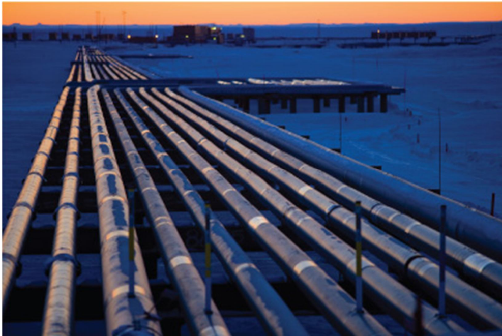
Figura 2.3 Red de tuberías de CO 2
