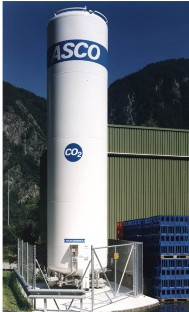
Figura 5.1 Tanque de almacenamiento de \text{CO}_2 vertical con capacidad de 37 ton, P_{\text{máx}} = 22.43\text{ km/cm}^2
