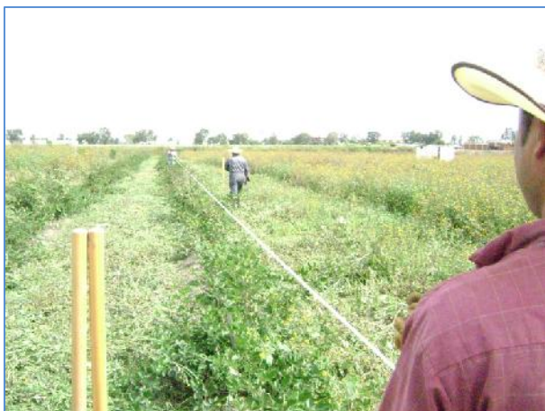
Foto 25: Se está tirando la línea para marcar donde se debe colocar el poste
