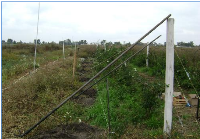
Foto 4: Presentación de cada uno de los tubos en el lugar que le corresponde
