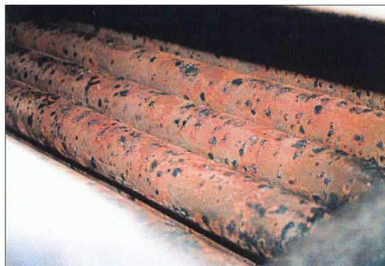
Figura 28. Corrosión por oxígeno (65).
