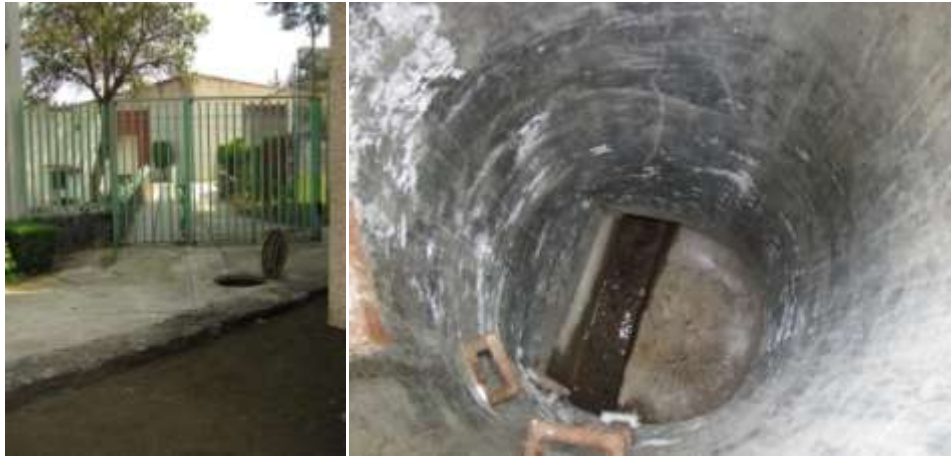
Figura 47. Verificación de flujo claro en el drenaje y audición de la posible caída en fuente cercana al pozo de visita
