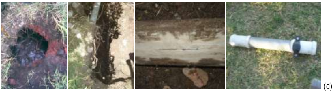
Figura 28. Fugas por fisura de tubos plásticos y de acero galvanizado de 2009 y 2010. Centro de Ciencias de la Atmósfera (a), Facultad de Economía (b), Registro de Aspirantes (c) e Institutos de Investigación en Humanidades (d).
