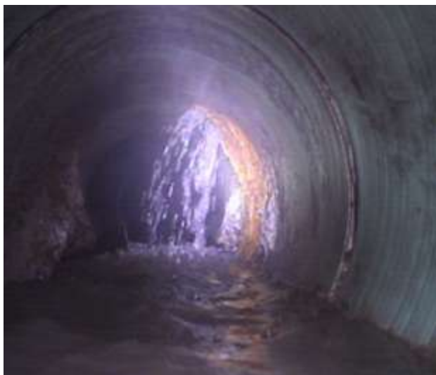
Figura 13. Intrusión de agua limpia a tubería de drenaje (fuente: Teasa)
