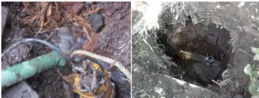
Figura 49. Descubrimiento y reparación de la fuga
