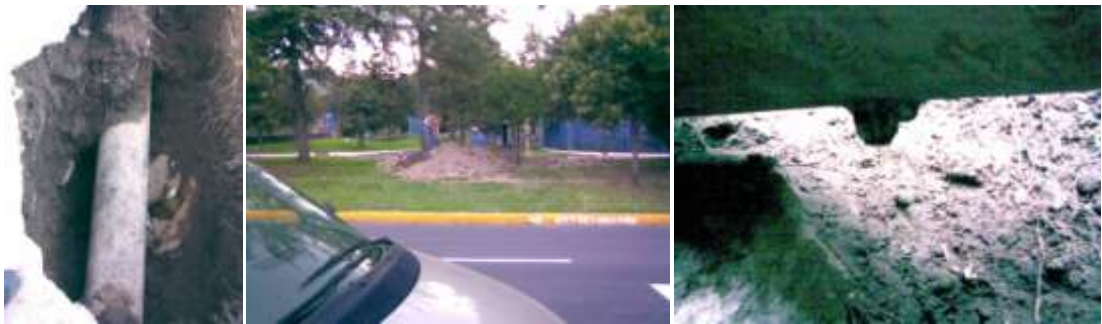
Figura 26. Fuga en fierro fundido de 12", tramo reparado por falla típica 5 veces en 3 años y su reparación (2008-2011)
