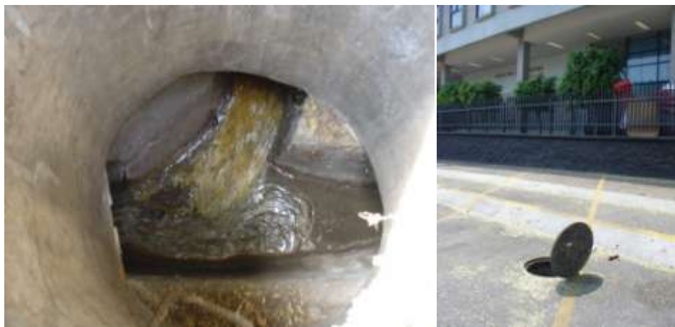
Figura 31. Pozo de visita en el estacionamiento de profesores de la Facultad de Economía. Descarga desde Auditorio CEDEM
