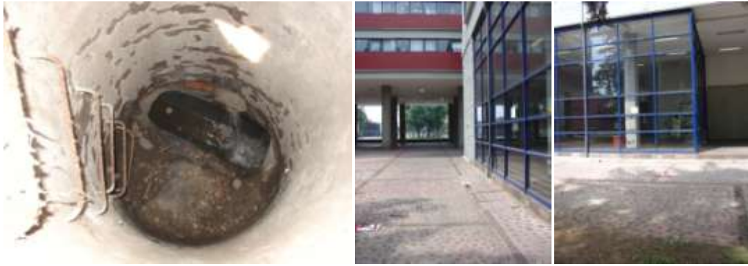
Figura 32. Pozo de visita de descarga directa del auditorio CEDEM. Sanitarios al fondo del lado derecho
