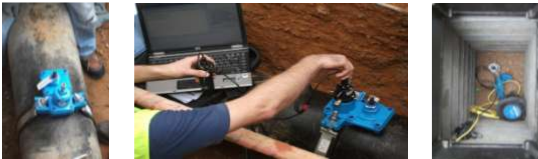
Figura 11. Instalación y puesta en marcha del sensor multifunción
