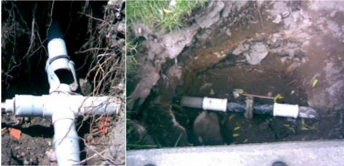
Figura 25. Fuga en PVC por asentamiento del terreno y su reparación en 2008
