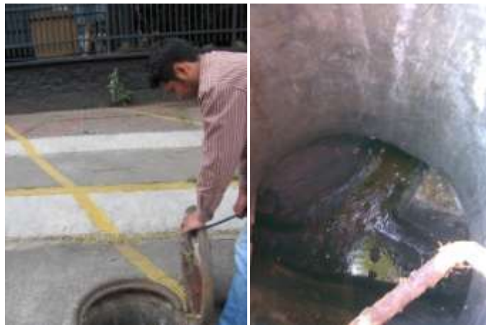
Figura 33. Pozo de visita en el estacionamiento de profesores de la Facultad de Economía. Flujo notablemente menor tras la reparación de la fuga de aproximadamente 3 lps.
