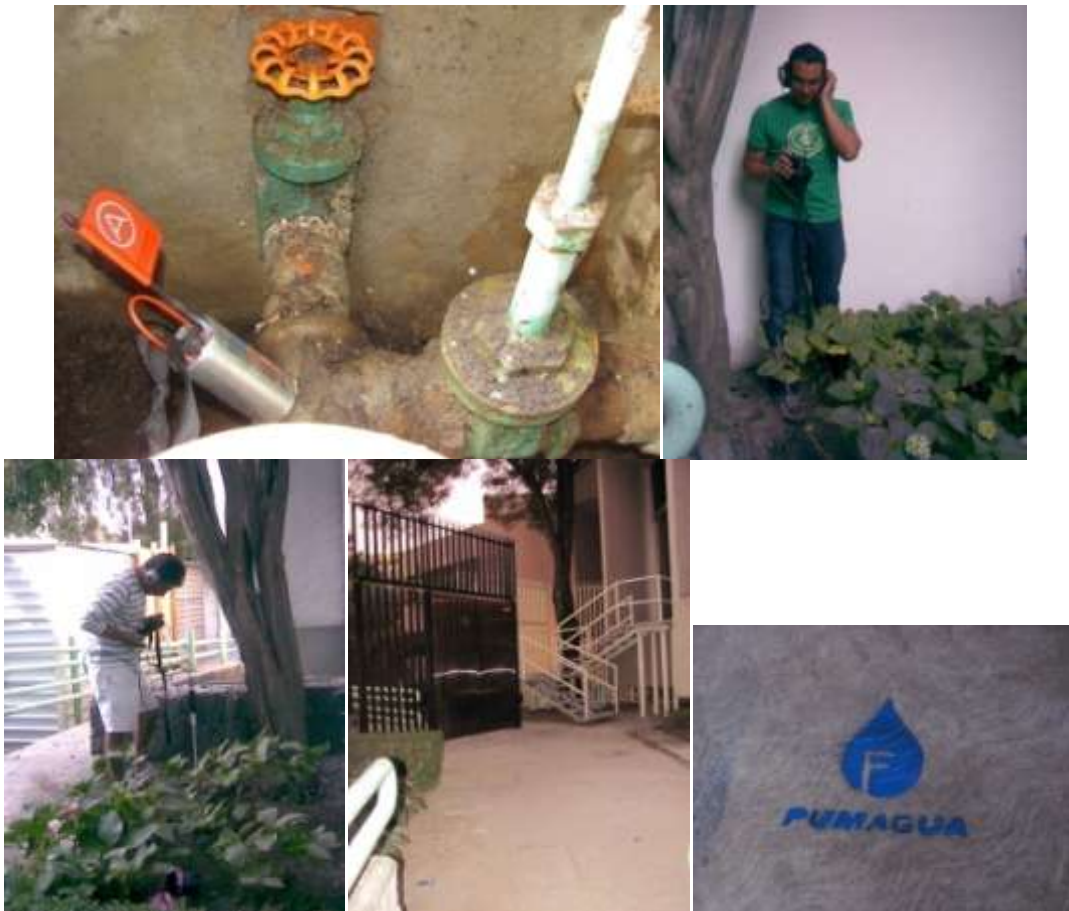
Figura 48. Correlación del tramo entre el R150 y R149 y confirmación de la fuga
