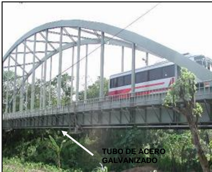
FOTOGRAFÍA 8 “TUBO DE ACERO GALVANIZADO EN PUENTE”
