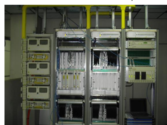
Equipos de Transmisión
