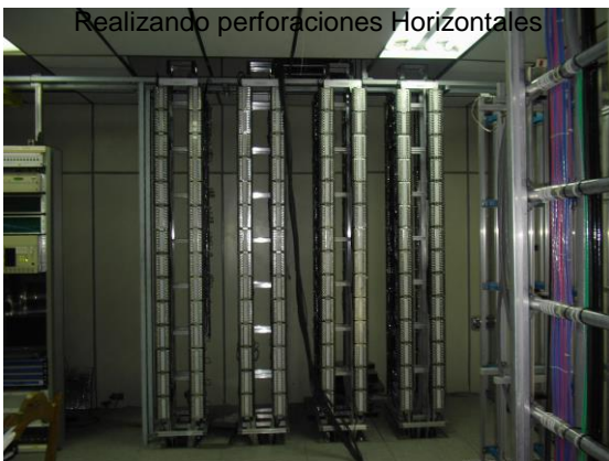
Equipos de Transmisión Multiplex
