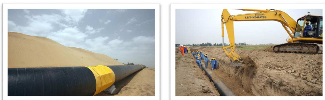
FIGURA 5. SISTEMA DE AISLAMIENTO TÍPICO DE LAS TUBERÍAS CON CALENTAMIENTO DE CRUDOS PESADOS Y EXTRAPESADOS (OLEODUCTO MÁNGALA, GUJARAT, INDIA) [7].
