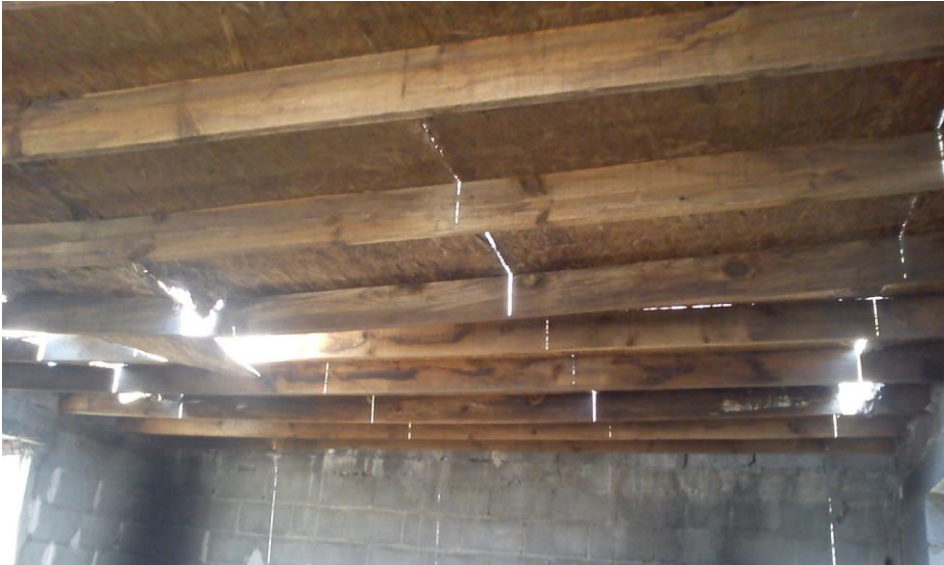
Imagen 44. Interior de una de las habitaciones de la casa. Las paredes de bloque sin aplanar y el techo de madera deteriorado. Fotografía de Gabriela Nava.
