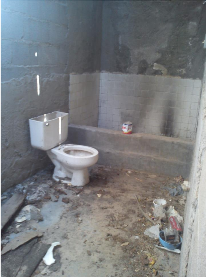
Imagen número 45. Interior del cuarto de baño, donde además de observarse las condiciones de deterioro, el análisis minucioso y dimensionamiento del área les planteo a los alumnos nuevas posibilidades espaciales. Fotografía de Gabriela Nava.
