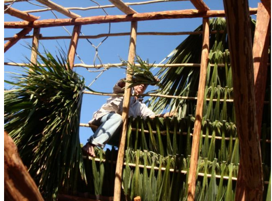
Fotografía 9. Construcción del techo de una casa tradicional maya en el socio-ecosistema de Nuevo Tesoco.
