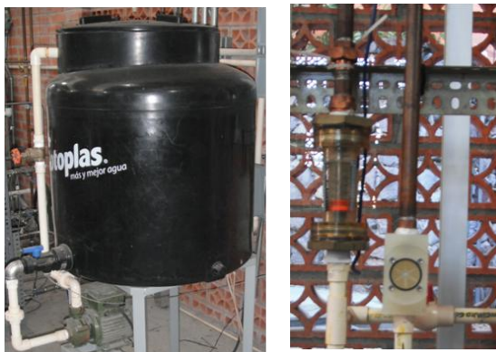
Figura 3.13. Tanque de almacenamiento y calentamiento de agua para ganancia térmica
