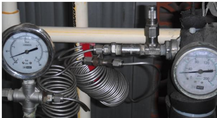
Figura 3.9. Válvula micrométrica marca Swagelok. Provoca el estrangulamiento-expansión del \text{NH}_3 líquido durante el efecto refrigerante. Presión de alta 15.8 bar absolutos, lado de baja 5.14 bar absoluto.
