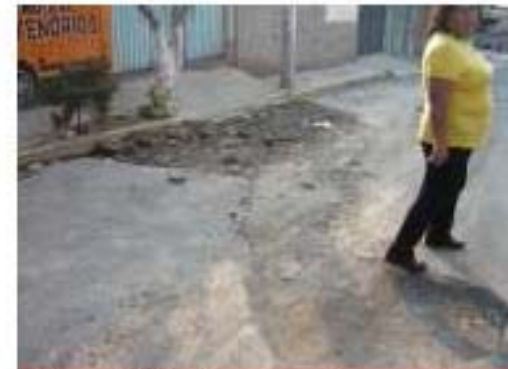
Obras hidráulicas inconclusas sobre calle Hllama en los límites de la colonia. Galería propia
