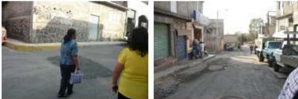
Problemas de bacheo sobre calle Calabaza y Fresno . galería propia
