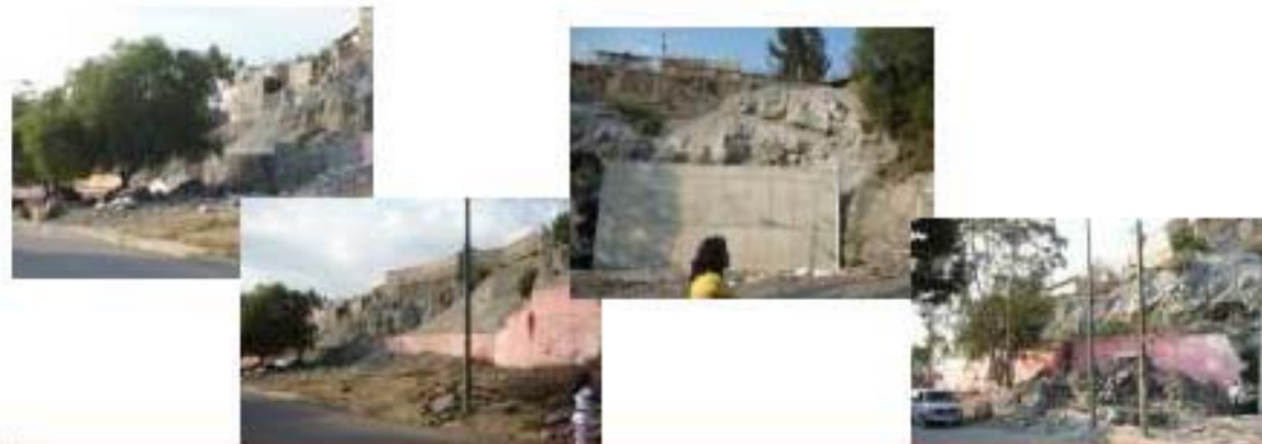
Riesgo de derrumbe por la falla de los muros de contención. Galería propia
