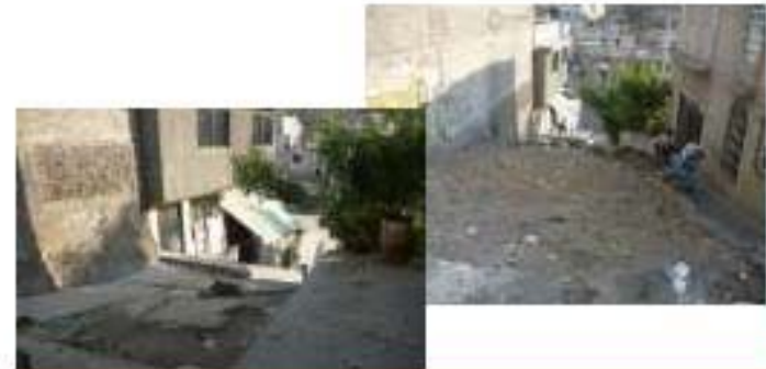
Deterioro de espacios comunes como escaleras .
