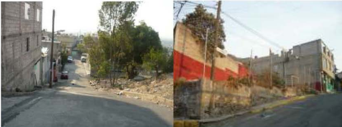
Las pendientes y la falta de mantenimiento provocan encharcamientos en periodos de lluvia
