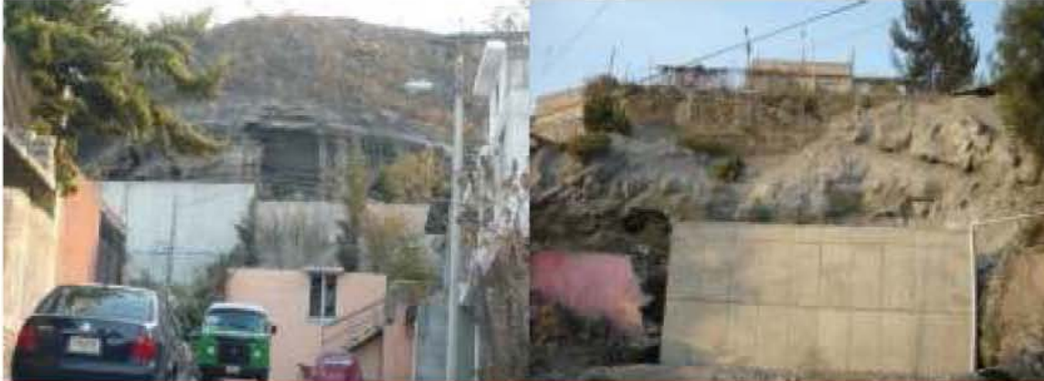
Riesgo de derrumbe en zona urbana. Los muros de contención son insuficientes.
