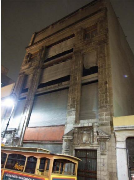
Foto 12. Edificio en deterior con bellos detalles arquitectónicos.
