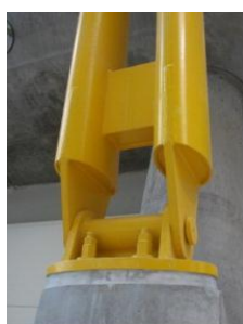
Ilustración 22 Ejemplo de unión a base de un pasador. (aeropuerto internacional de Barajas, Madrid)
