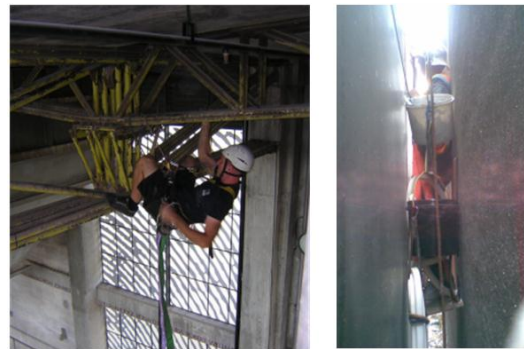
Ilustración 57 Ejemplos de situaciones en las que no se ha tomado en cuenta el equipo de seguridad o la holgura para llevar a cabo labores de mantenimiento o desensamble.
