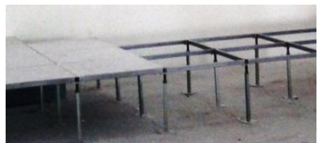
Ilustración 53 Ejemplo de piso falso colocado en SITE de edificio corporativo
