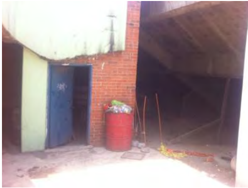
Vista del desgaste de instalaciones.
