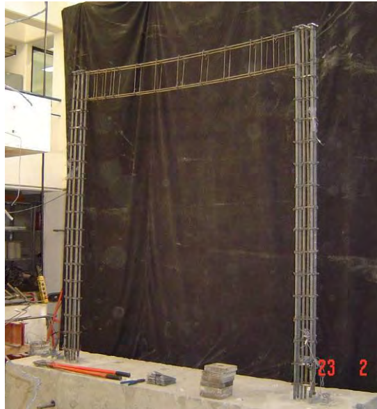
Figura L.7 a) Armado de los muros sin refuerzo en el alma (MCN0M, MCC0M)
