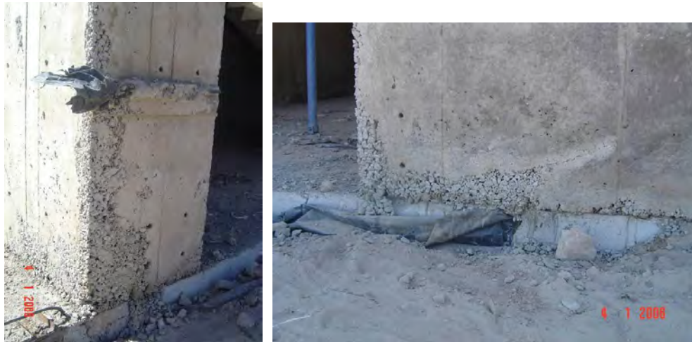
Figura C.1 Falta de vibrado en las esquinas inferiores de los muros
