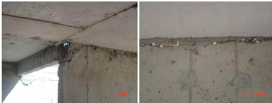
Figura C.2 Detallado deficiente en la interfase losa-muro
