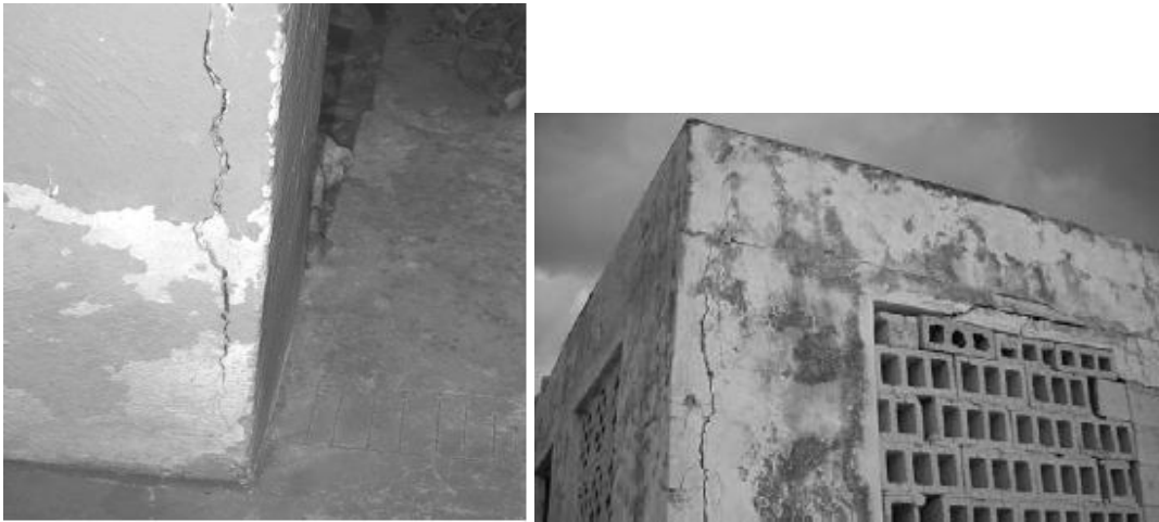
Figura 2.19 Agrietamientos por corrosión del acero de refuerzo en viviendas (Solís et al., 2005)
