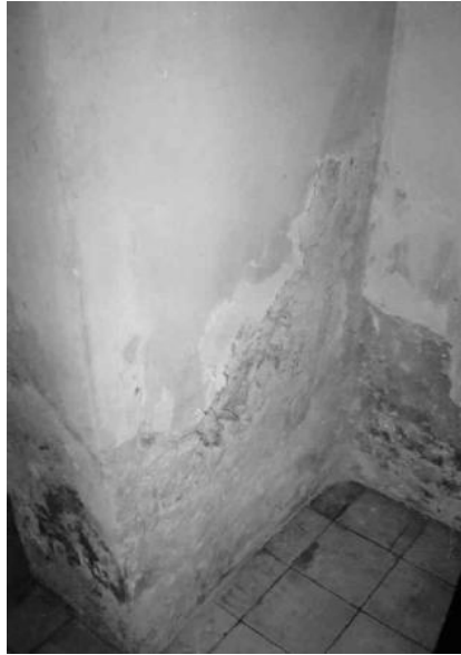
Figura 2.21 Daños en un muro de concreto por humedad (Solís et al., 2005)
