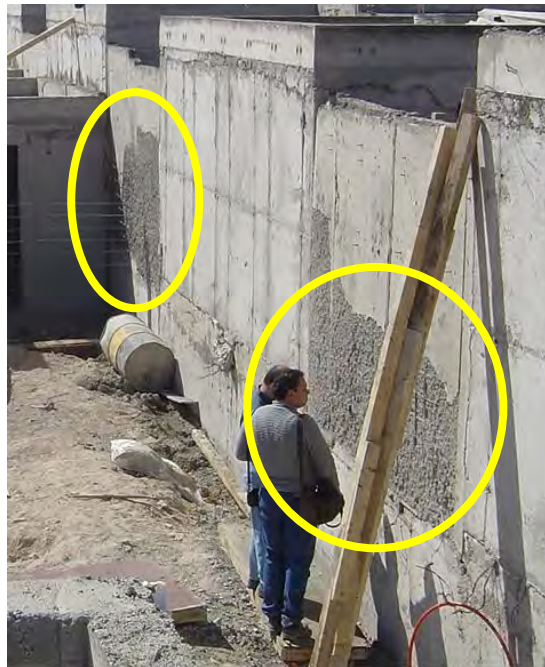
Figura C.3 Muros de concreto demolidos en su parte inferior
