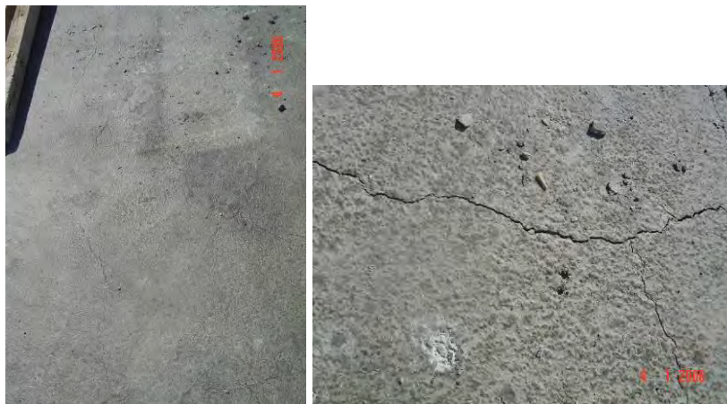
a) Agrietamiento en losas
