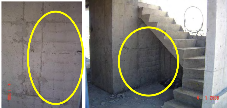
Figura C.4 Consecuencias de una sujeción deficiente de la malla electrosoldada
