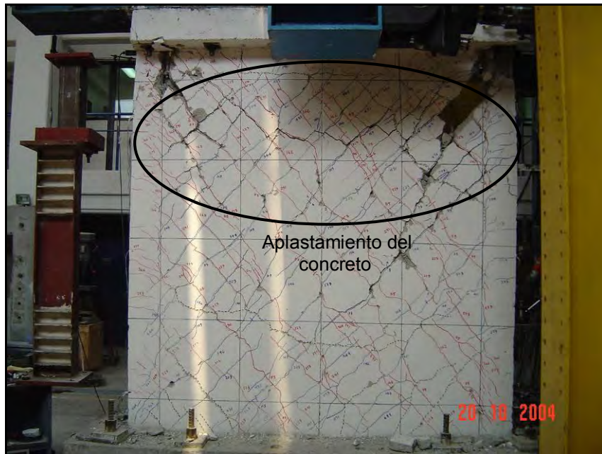
Figura S.31 Estado final de daño del muro MCA100C
