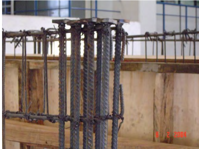
Figura L.8 Detalle del anclaje mecánico de las barras de refuerzo vertical de los elementos de borde
