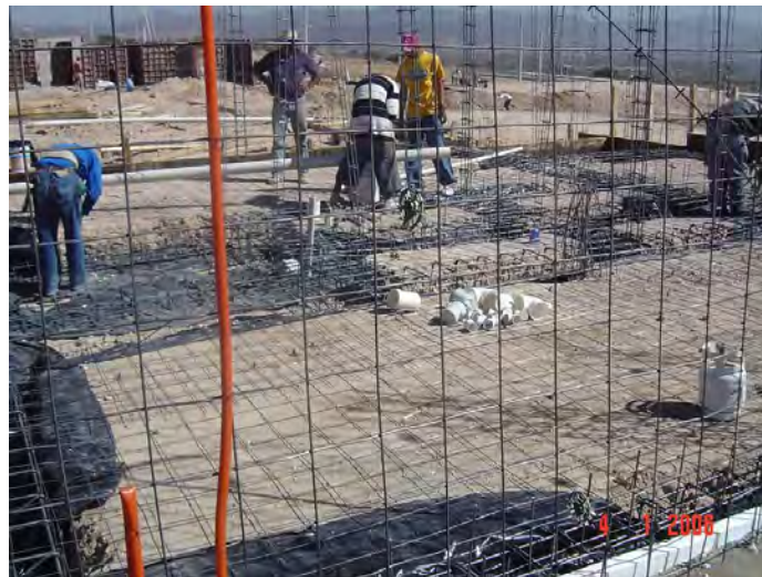
Figura B.2 Preparación de la losa de cimentación de una vivienda de concreto
