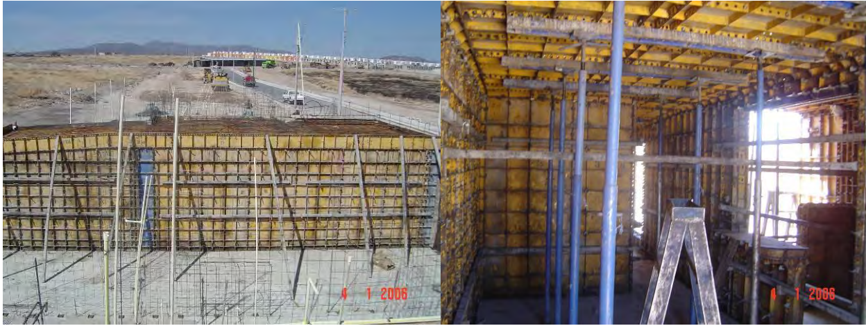
Figura B.5 Arreglo de la cimbra para el colado monolítico de muros y losa de concreto en viviendas
