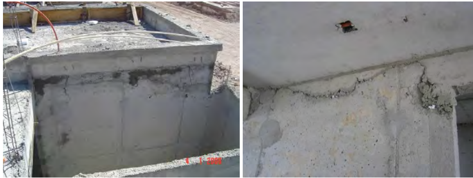
Figura C.2 Detallado deficiente en la interfase losa-muro (continuación)
