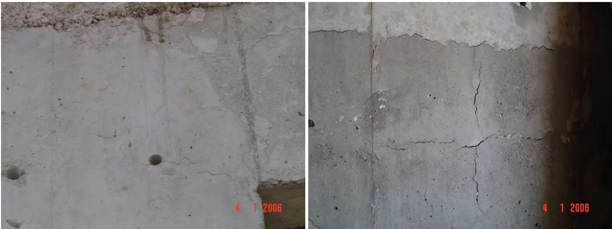
b) Agrietamiento en muros
