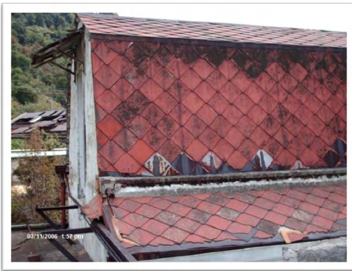
Cubierta de la mansarda lateral, con desprendimientos de piezas de asbesto
