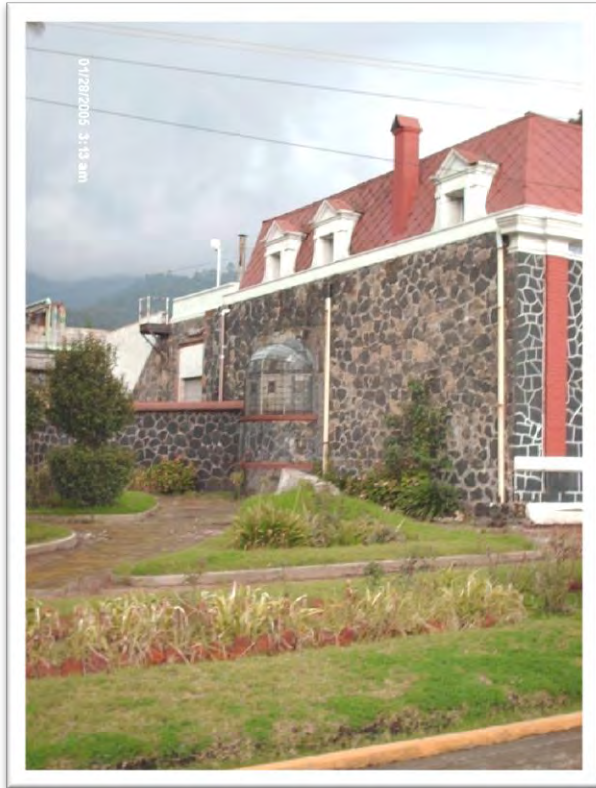
Fachada lateral, se observan adaptaciones de bajadas de agua
