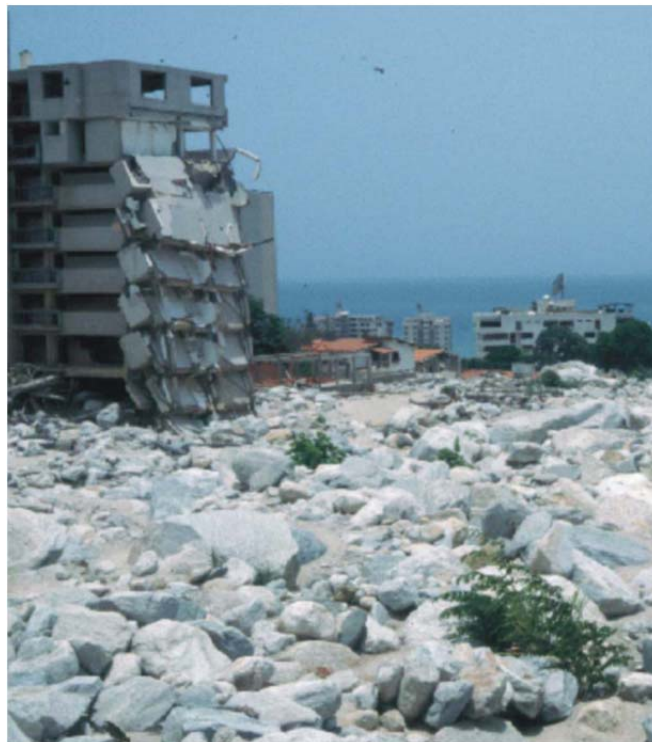
Figura V.2.- Daños a edificios por impacto de bloques en pilares (Cortesía Zhang & Sucheng, 2000).
