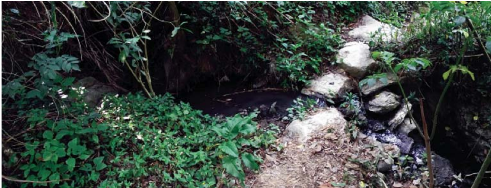
Salida drenaje ZONA 4; salida a cañada abierta
