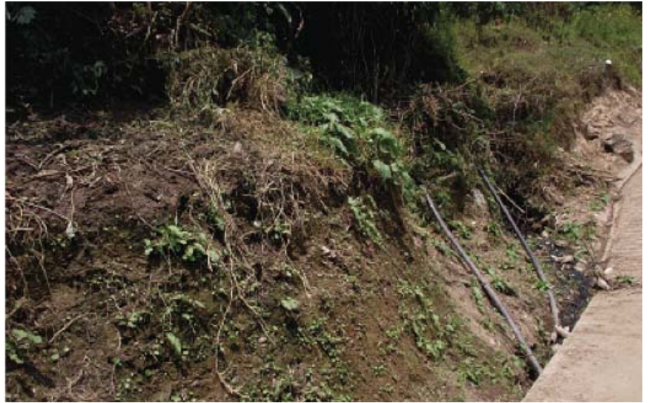
Salida drenaje ZONA 3; salida a cañada abierta
