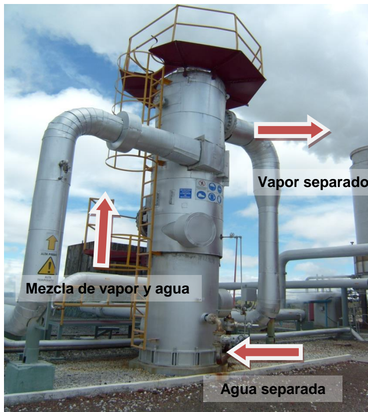
Figura 3.1 Separador centrífugo, campo geotérmico Los Humeros, Puebla. (La mezcla de vapor y agua proveniente del pozo geotérmico es separada en vapor y en agua)
