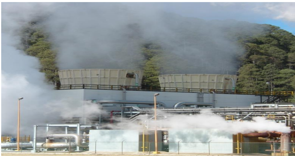
Figura 3.3 Torre de Enfriamiento. Los Azufres, Morelia
