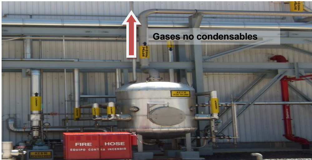
Figura 3.4 Separador de gases Los Azufres Morelia (Los gases no condensables son enviados a la atmosfera)
