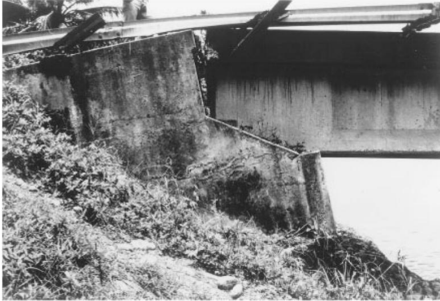
a) Rotación del estribo debido al efecto de licuefacción y corrimiento lateral del material de relleno
