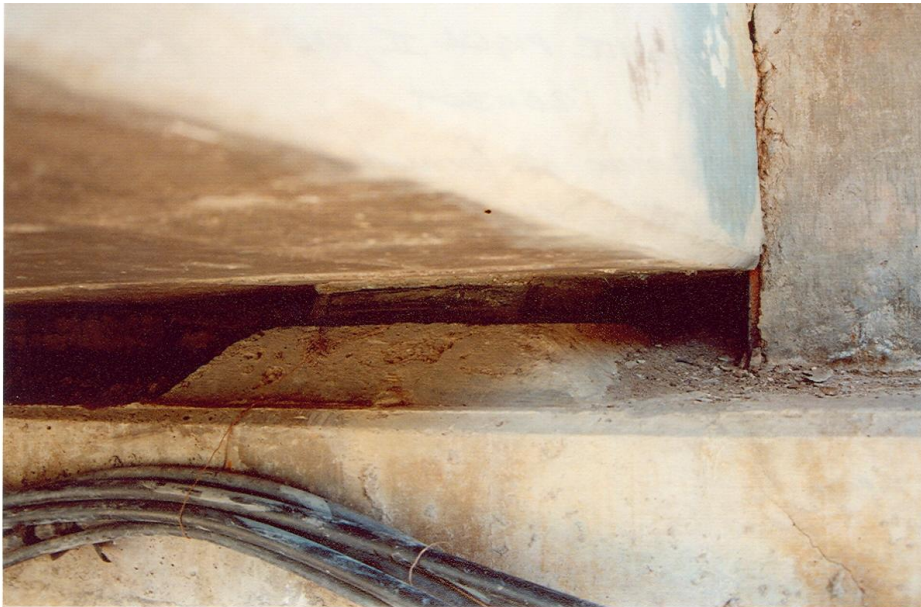
Figura 1.27 Dispositivo de asiento de un apoyo del Puente Pigua II, Tabasco (SIPUMEX)
