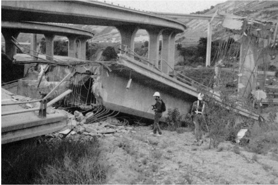
Figura 2.4 Vista general del colapso del I-5/14 South Connector
