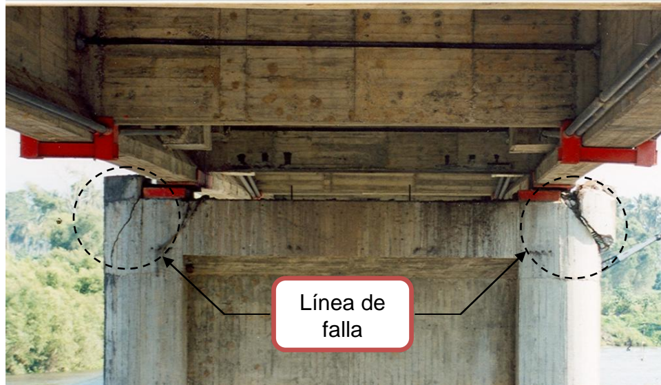
Figura 2.24 Daño severo en topes laterales del Puente Coahuayana
