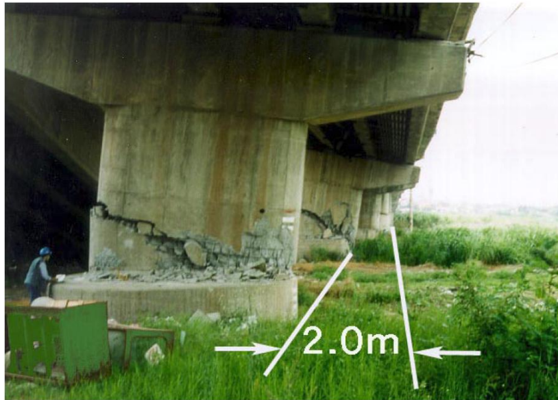
Figura 2.21 Falla por Cortante de las Pilas P1 y P2 del Puente Sur Wu-Shi, (Sismo de Chi Chi 1999)
