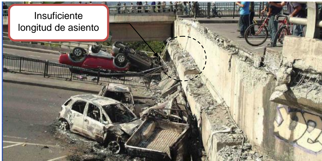
Figura 2.33 Colapso de un tramo del Puente Llacolen
