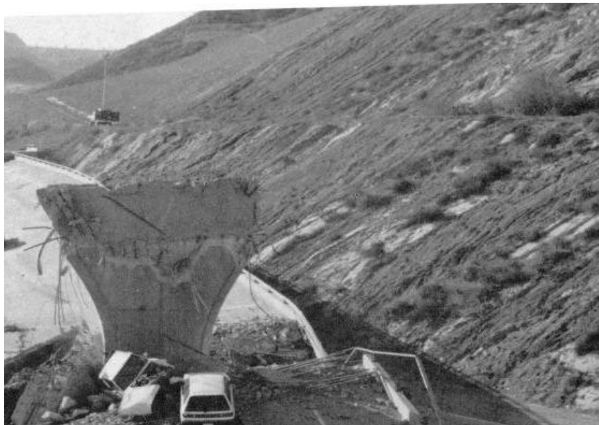
Figura 2.5 Vista de la columna acampada del I-5/14 South Connector
