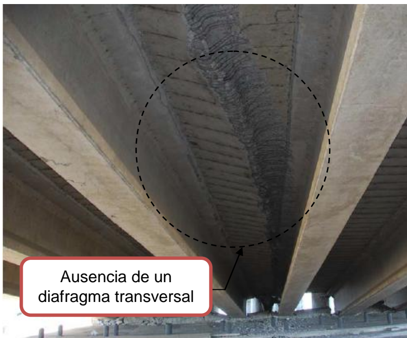
Figura 2.32 Falla del tablero del Puente Llacolen
