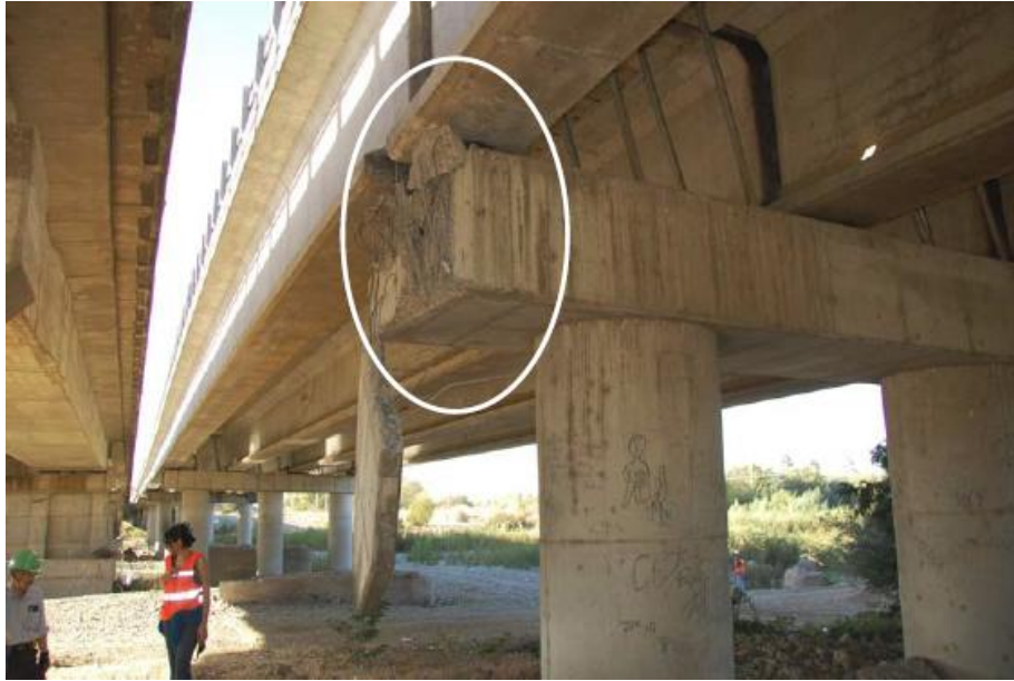
Figura 2.35 Daño severo en un elemento de restricción lateral
