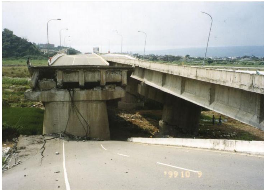
Figura 2.20 Colapso de la cubierta del Puente Wu-Shi, (Sismo de Chi Chi 1999)
