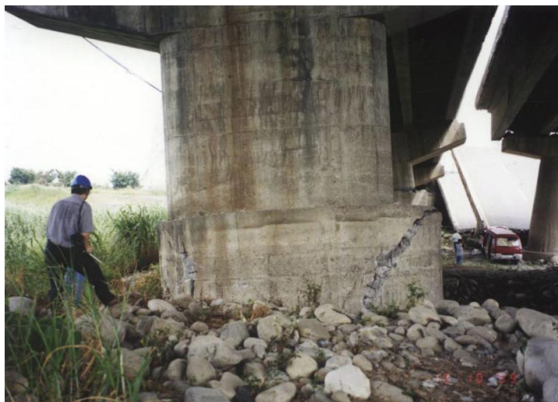
Figura 2.22 Falla por cortante del cajón de cimentación de la Pila P3, (Sismo de Chi Chi 1999)
