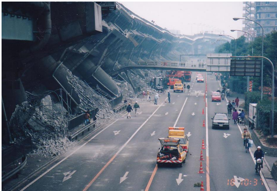
Figura 2.10 Colapso total del Viaducto Fukae, (Sismo de Kobe, 1995)
