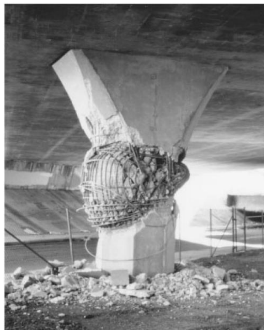
b) Falla local de la columna acampanada debido al deficiente detallado del refuerzo por confinamiento
