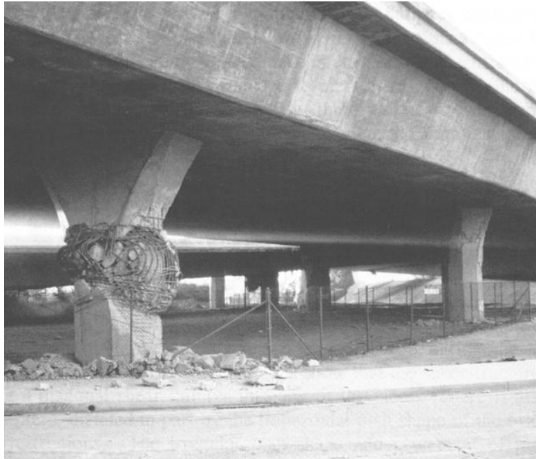
a) Vista general de los daños observados en el Puente
