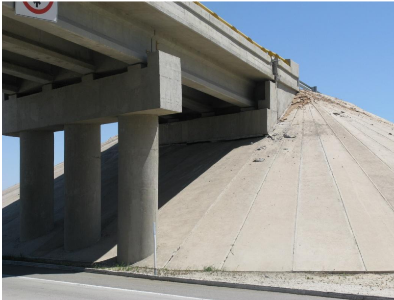
Figura 1.24 Marco central del Puente ubicado en el Libramiento de Mexicali Km. 9+400, en Baja California Norte (SIPUMEX)
