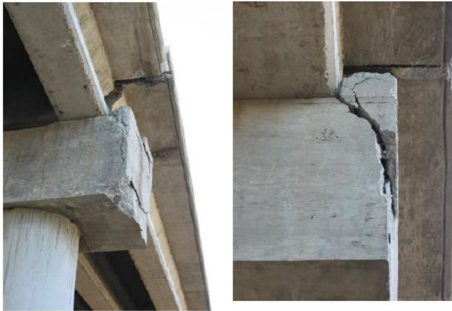
Figura 2.29 Daño en topes laterales y desfase de su posición original de las vigas precoladas en el Puente “Manzanillo”
