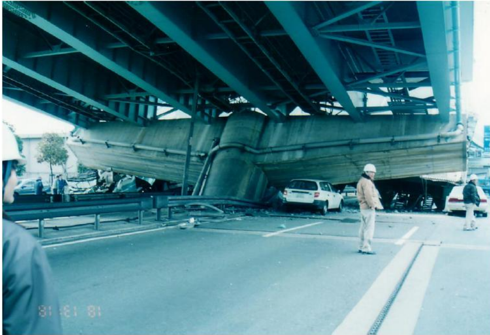
Figura 2.13 Colapso de apoyo del Viaducto Takashio, (Sismo de Kobe 1995)
