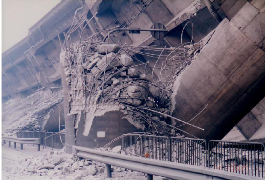
Figura 2.12 Falla prematura por cortante en la columna del Viaducto Fukae
