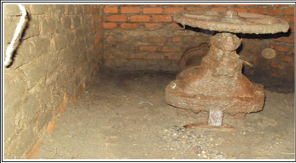
FOTO No. III.7.- Se muestra la inspección de una caja de válvulas la cual se encuentra azolvada hasta la mitad.
