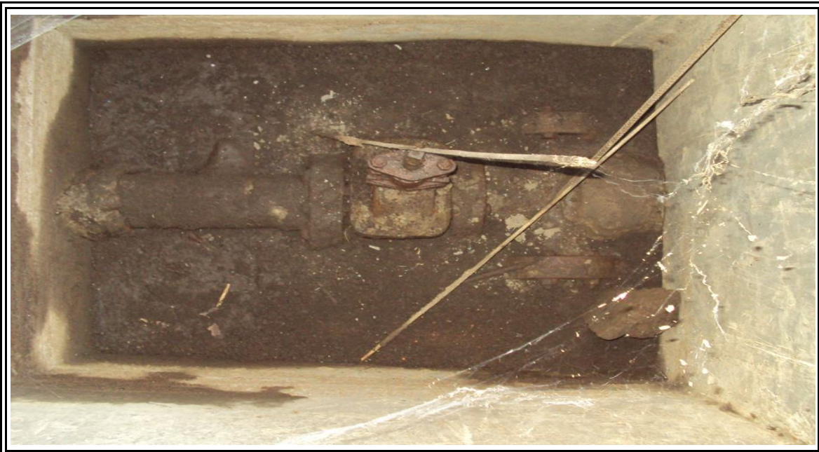
FOTO No. III.6.- Se muestra la inspección de una caja de válvulas la cual se encuentra en un estado muy deteriorado.
