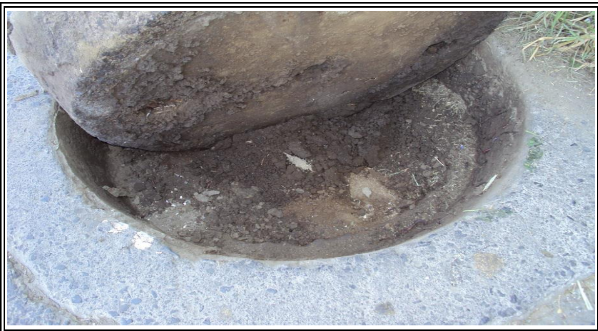
FOTO No. III.8.- Se muestra un pozo de visita el cual se puede observar que se encuentra totalmente azolvado.
