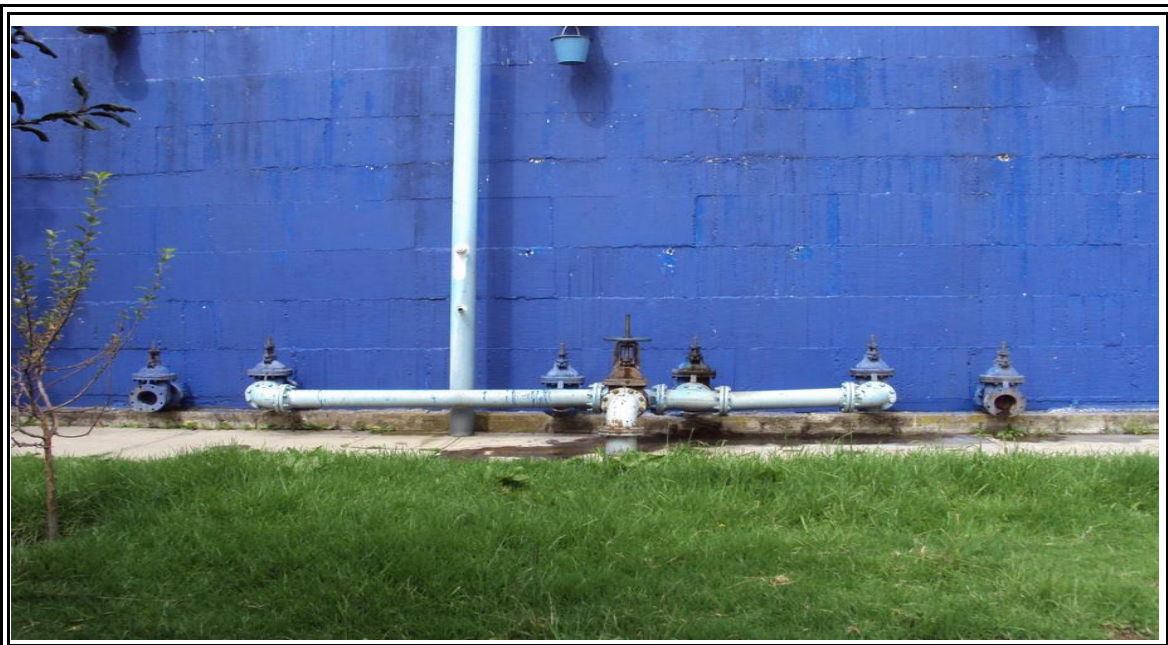
FOTO No. III.2.- Se muestra el tanque en su cara con dirección al este, donde se conectará nuestra línea de proyecto para abastecer a la parte baja de Milpa Alta.
