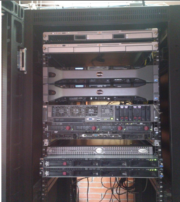
Figura 6.4.8 Servidores instalados en el Rack de RDI
