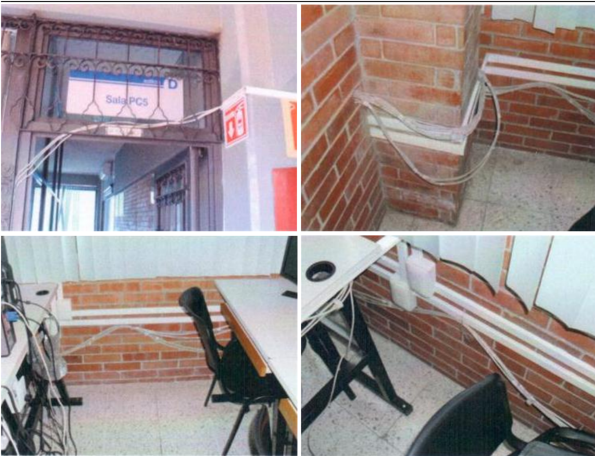
Figuras 6.1.8.16; 6.1.8.17; 6.1.8.18 y 6.1.8.19 Cableado Sala PC5
