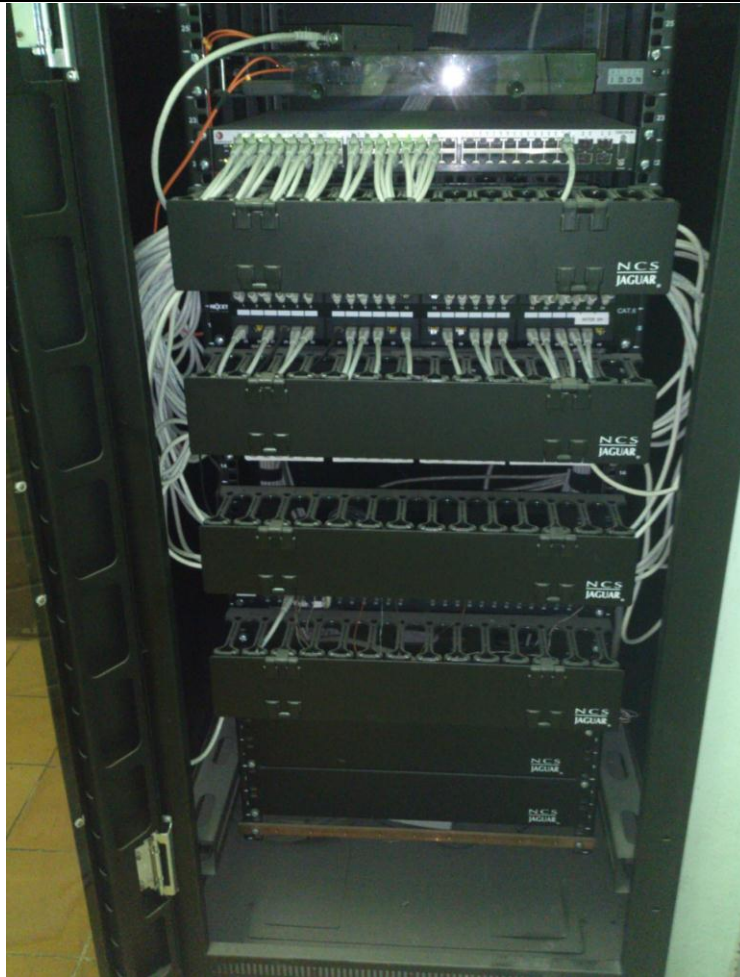
Figura 6.4.12 Rack de Comunicaciones de Rectoría
