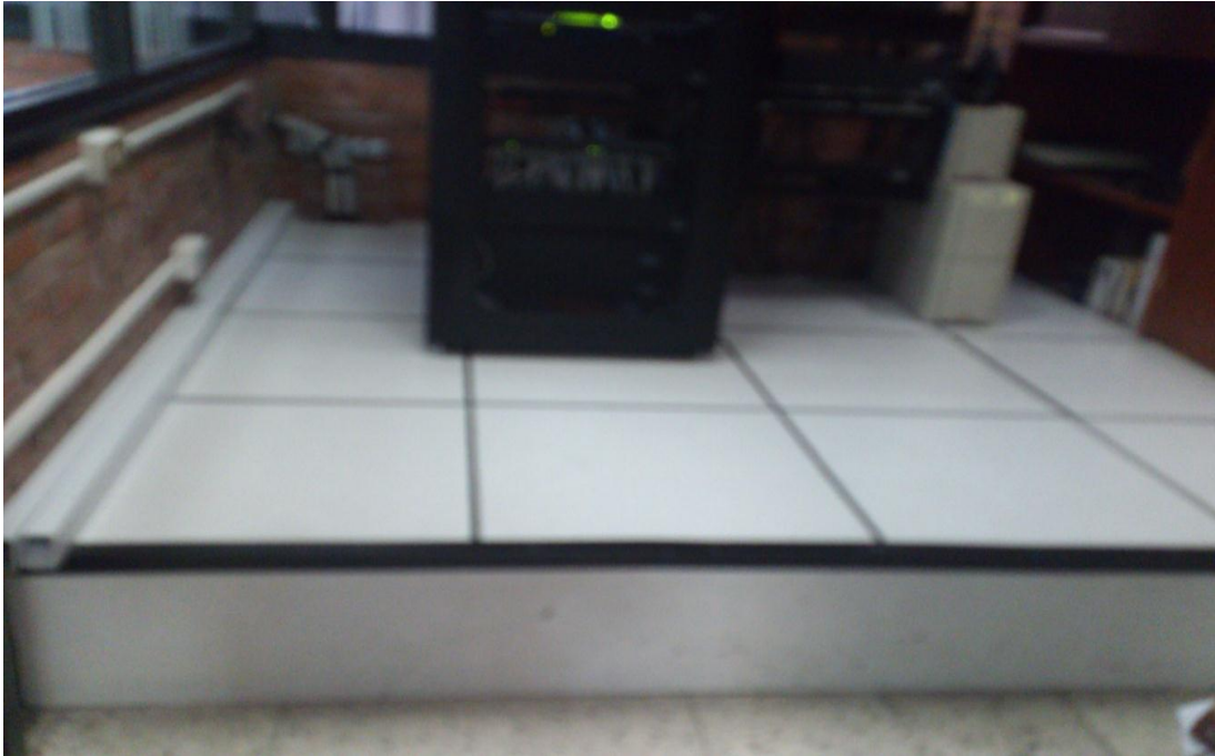
Figura 6.4.3 Piso falso del Site de CTI
