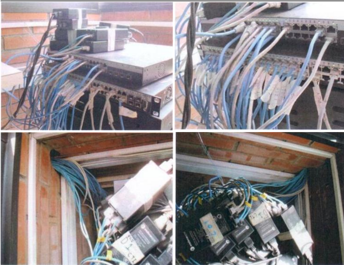
Figuras 6.1.8.4; 6.1.8.5; 6.1.8.6 y 6.1.8.7 Switches e inyectores sala PC2
