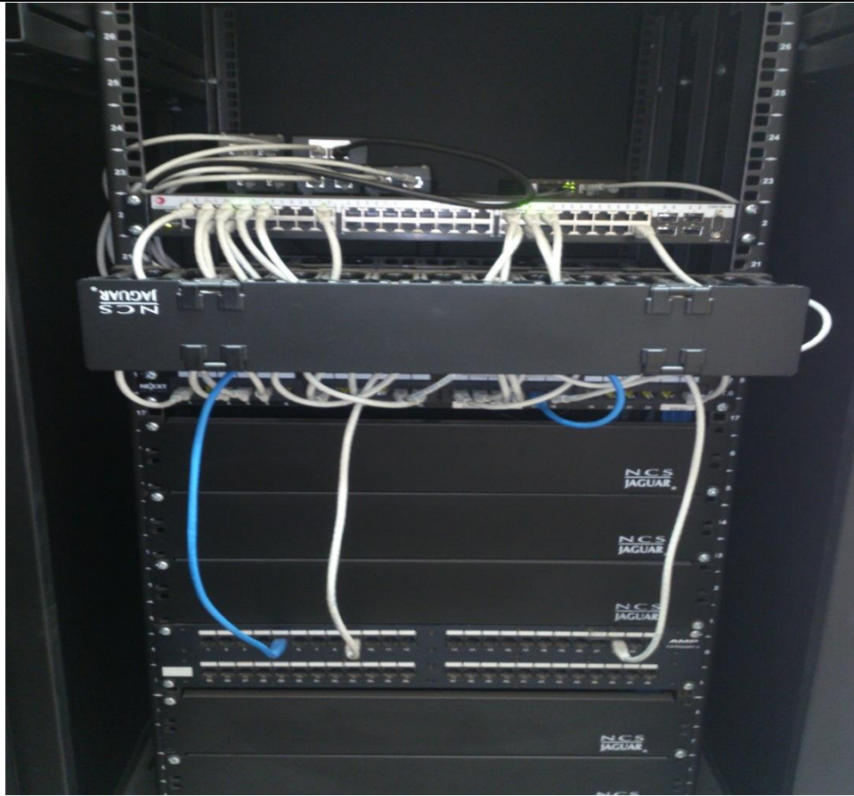
Figura 6.4.9 Rack de Comunicaciones en Centro de idiomas
