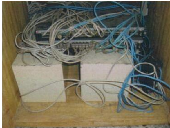
Figura 6.1.8.20 Switches y cableados en sala MAC1
