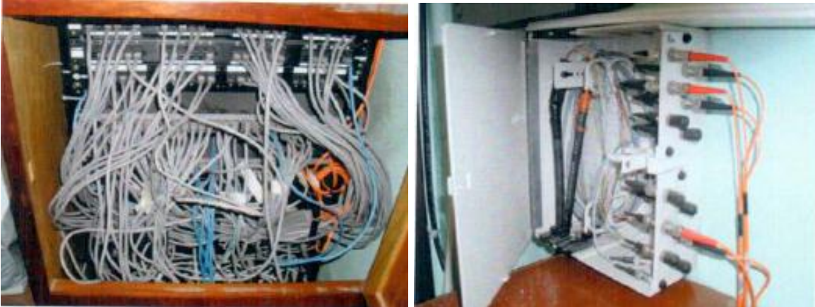
Figuras 6.1.8.36 y 6.1.8.37 Gabinete de comunicaciones y Acometida de Fibra Óptica localizados en la Primaria
