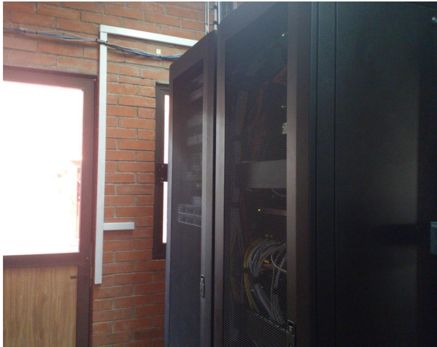
Figura 6.4.6 Gabinetes instalados en el Site de RDI
