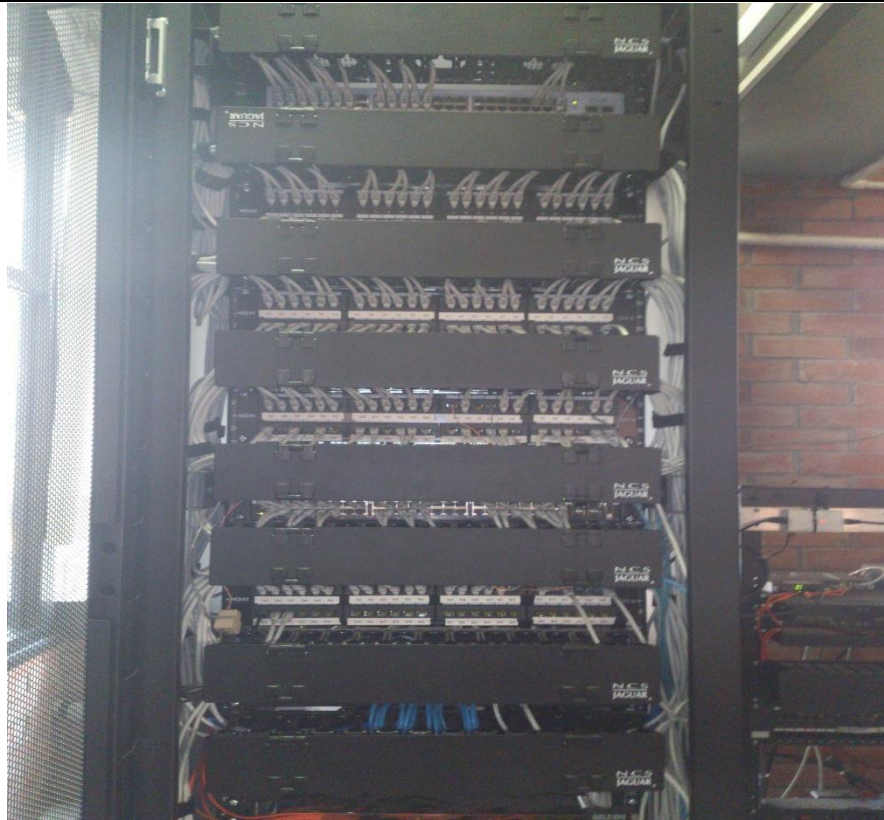
Figura 6.4.1 Rack de Comunicaciones localizado en CTI
