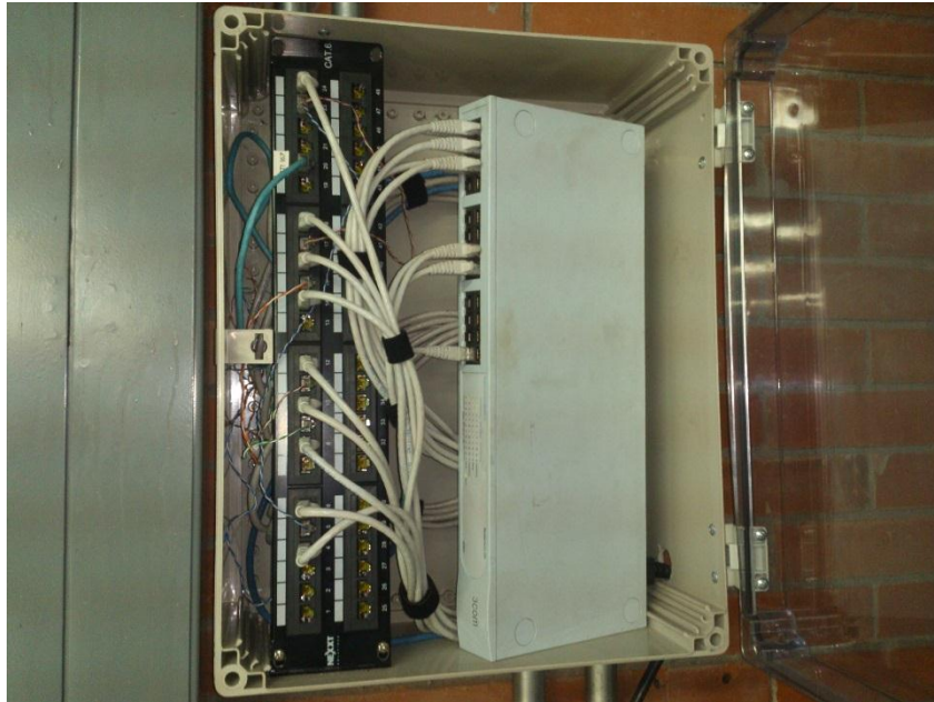
Figura 6.4.5 Gabinete instalado en planta piloto
