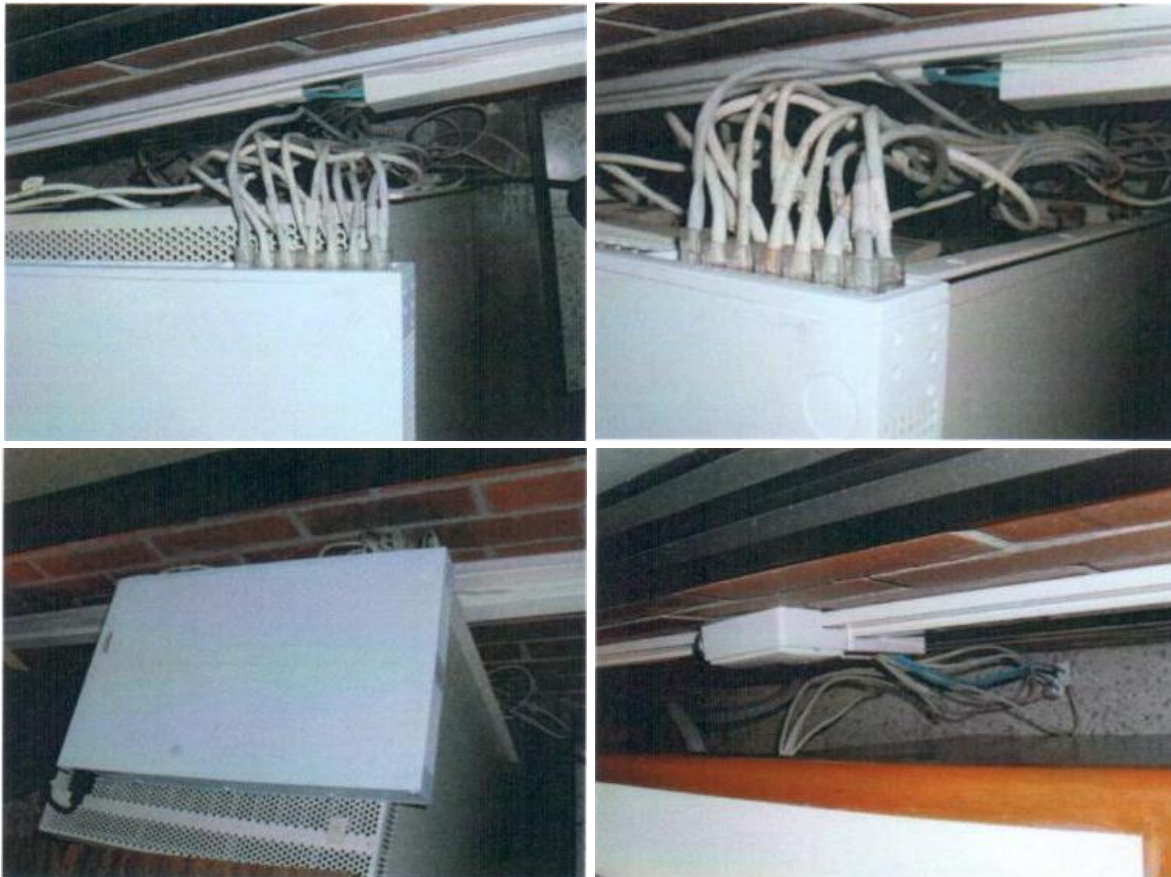
Figuras 6.1.8.12; 6.1.8.13; 6.1.8.14 y 6.1.8.15 Switch 3com localizado en PC4
