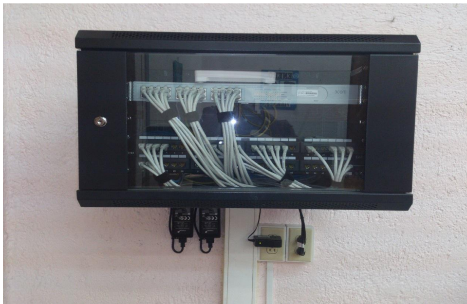
Figura 6.4.10 Gabinete localizado en Biblioteca
