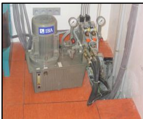
Fig.2.11 Bomba de recirculación.
