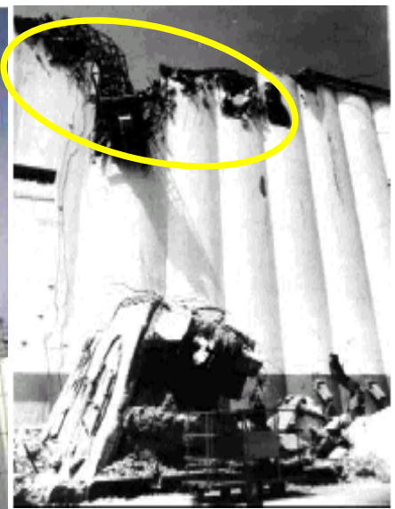
Fig. 3.3 Colapso de silo por fuerza sísmica en 1964, Lima Perú. Tomado de Ref. 2 “Causas de Daños y fallas en silos”
