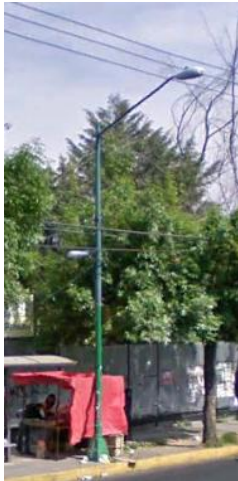
Tipo de luminarias del alumbrado público
