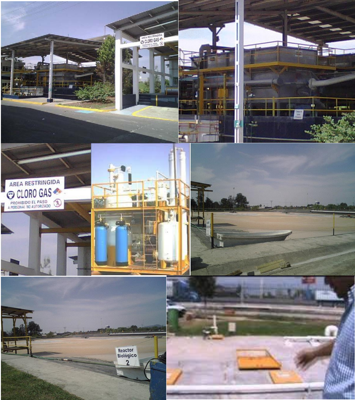
ILUSTRACIÓN.2.5.10 PLANTA TRATADORA DE AGUAS RESIDUALES EN LA PAPELERA SCA
