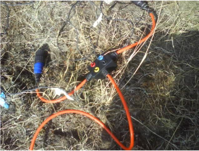
Figura 4. 23 Detalle de la conexión de los cables de corriente y Voltaje.
