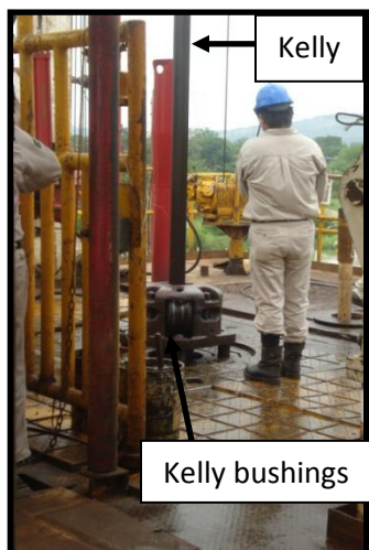
Fig. 2. 1 La flecha logra girar por la rotación del Kelly bushings el cual forma parte del sistema de rotación del equipo del equipo de perforación. Pozo Mecatepec 118, Tihuatlan, Veracruz.
