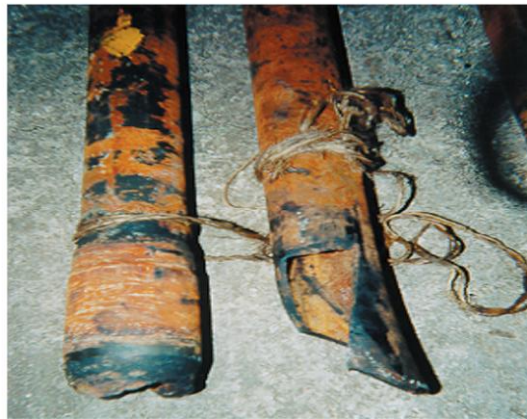
Fig. 3. 29 Agrietamiento de la tubería por H 2 S.
