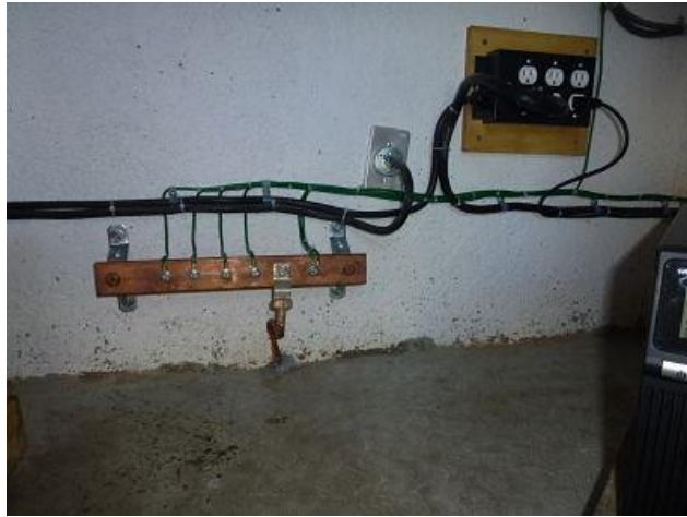
Figura 24 Barra de Tierras de Telecomunicaciones.
