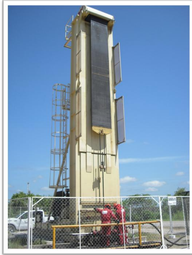
Figura II-13 Unidad Rotaflex de bombeo de carrera larga.
