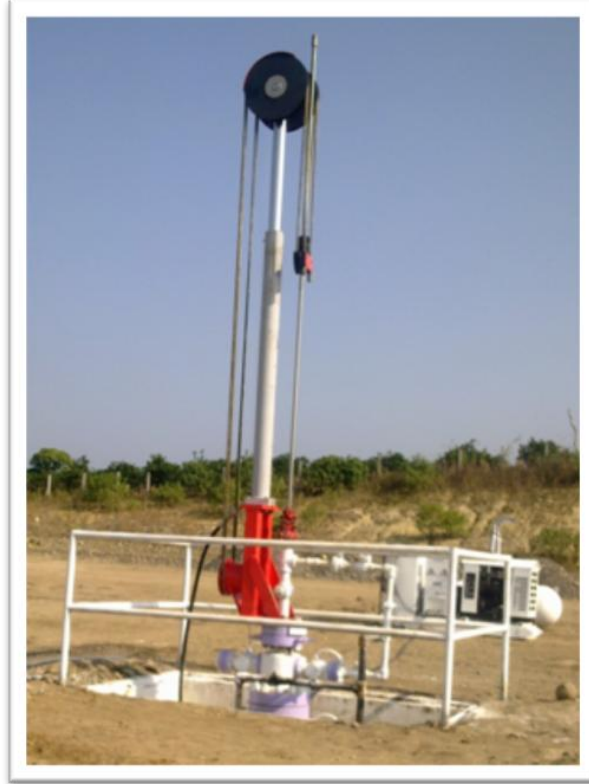
Figura II-14 Unidad Corlift de bombeo mecánico.
