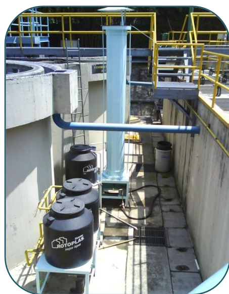
a) Reactor UASB
