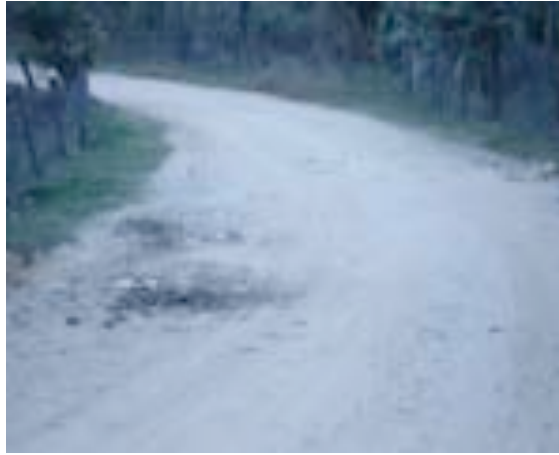
fig. 14. Condiciones de la carretera a Huehuetónoc.
