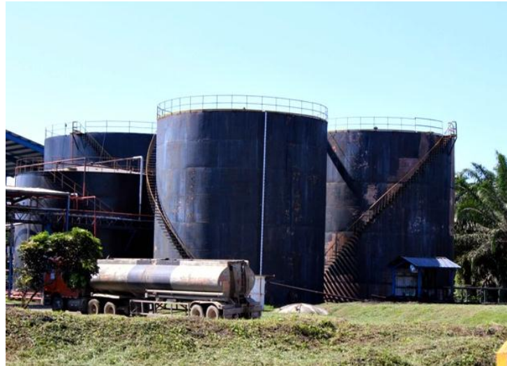
Figura 24. Tanques de Almacenamiento
