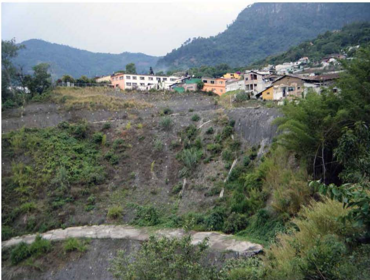
Figura iv. Vista del deslizamiento de la calle Cinco de Mayo. (Foto tomada por Matilde Cruz).
