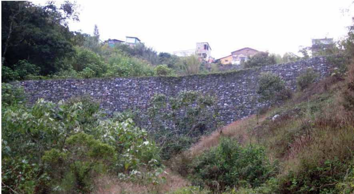
Figura. 2.10. Gavión del deslizamiento de la calle Cinco de Mayo.
