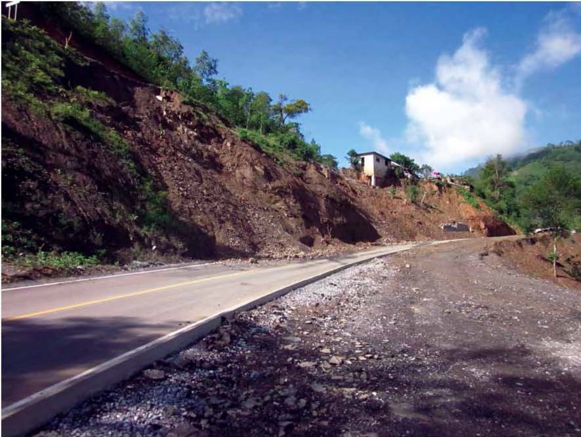
Figura. 2.14. Deslizamiento en la carretera de Xolotla a Mamiquetla ocurrido en 2012.
