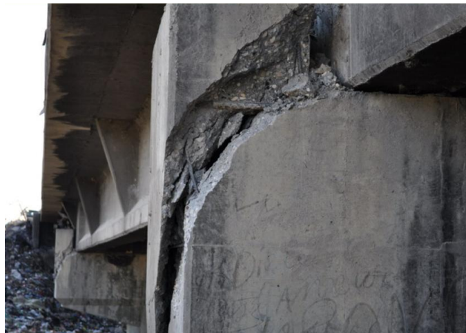
Figura 1.9. Daños en topes sísmicos de un puente de Puerto Príncipe por la ocurrencia del temblor de Haití del 12 de enero de 2010
