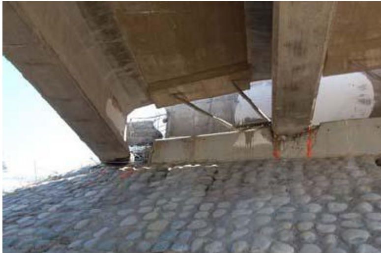
Figura 1.10. Daño en topes sísmicos del puente Las Mercedes (Chile), debido al sismo del 27 de febrero de 2010
