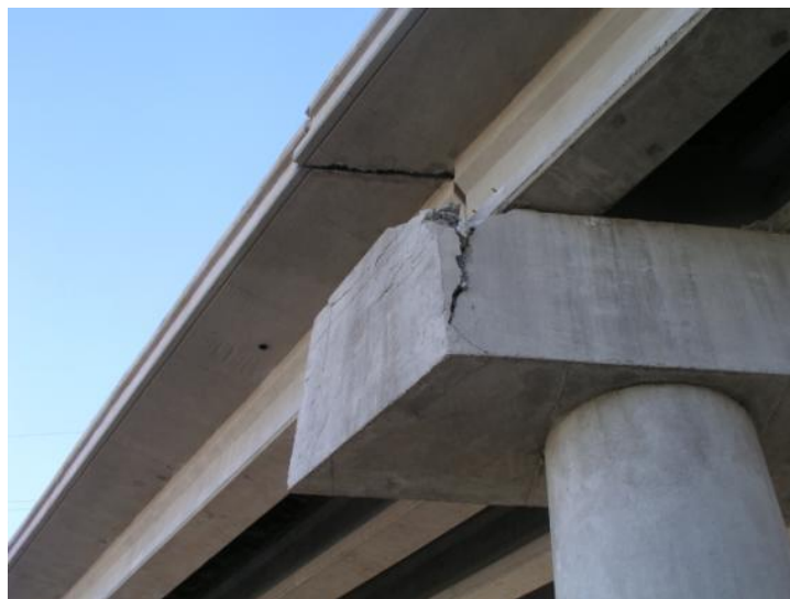
Figura 1.11. Daño en topes sísmicos de un puente localizado en el tramo Mexicali-Tijuana, debido al sismo de 4 de abril de 2010
