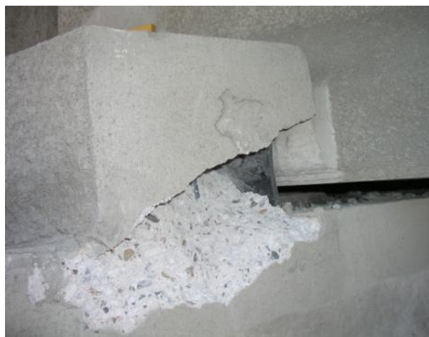
Figura 1.12. Detalle del daño en topes sísmicos con placa neopreno lateral de un puente localizado en el tramo Mexicali-Tijuana, debido al sismo del 4 del abril de 2010
