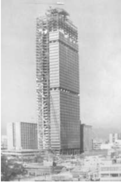
Figura 2.6. Torre Ejecutiva Pemex, en proceso de recubrimiento de la estructura con vidrio espejo.
