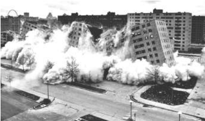
Figura 3.4. Después de convertirse en una zona de marginación, delincuencia y violencia urbana, las autoridades deciden su demolición en 1972.
