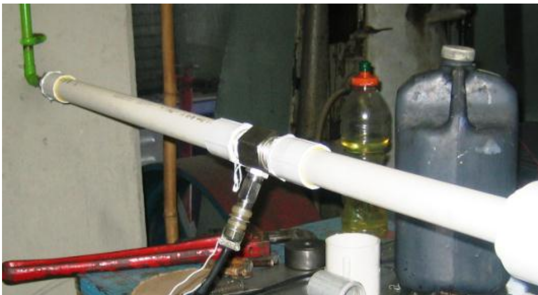
Figura 45. Conexión del Transductor de flujo de suministro
