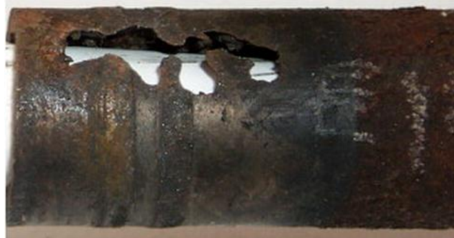
Fig. D3: Erosión por alta velocidad del gas y presencia de sólidos en la corriente de fluidos
