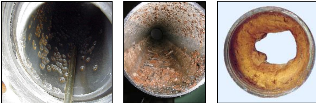
Fig. (B8): La corrosión, el desgaste y las incrustaciones en tuberías disminuyen la eficiencia de flujo.
