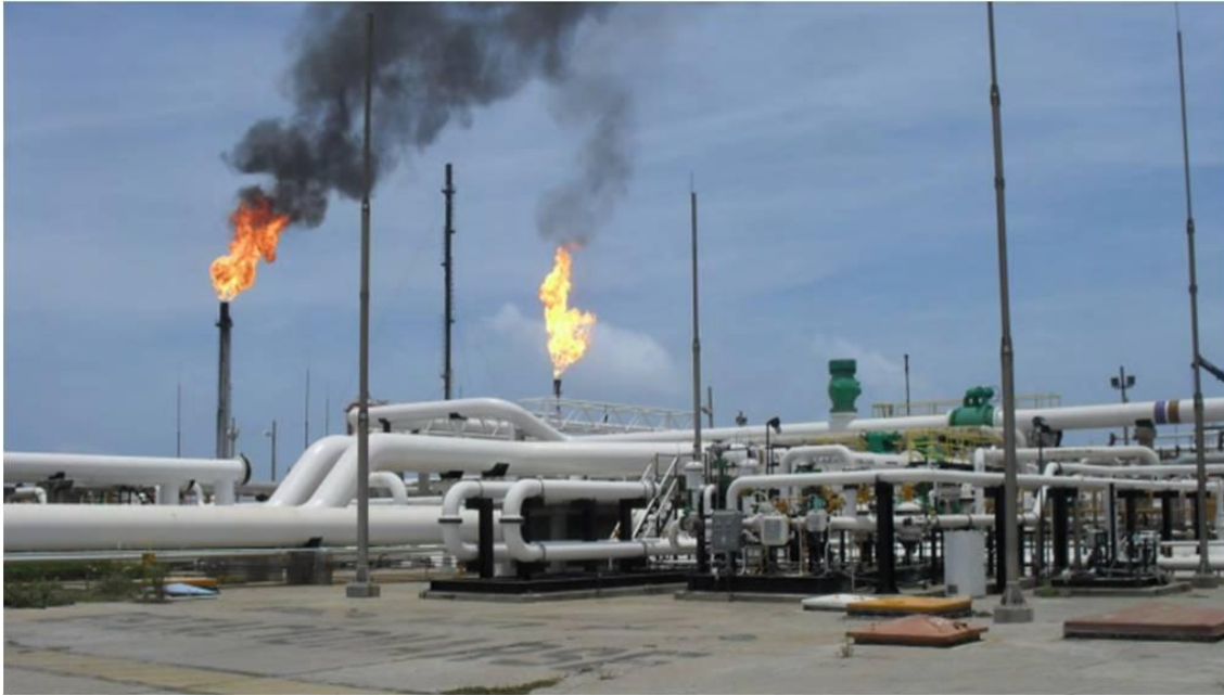
Fotografía 3.1.- Sistema de Desfogue
