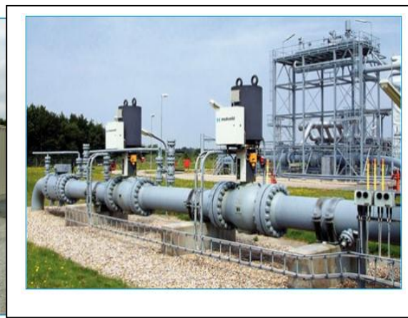
Fig. 2.6 1o02 HIPPS electrónicos proteger ASME 600 instalación frente a la presión de ASME de tuberías 900 (Cortesía de Mokveld)
