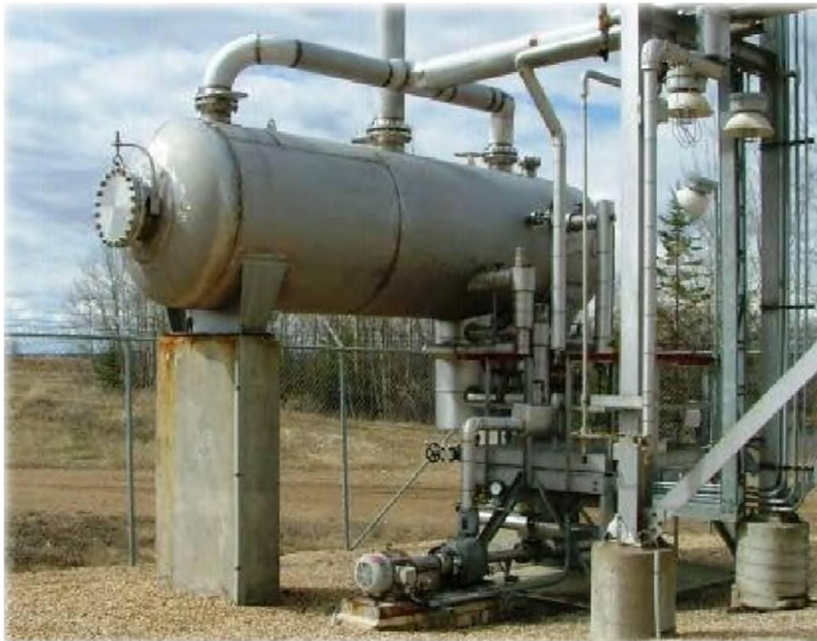
Fotografía 3.2.- Tanque de desfogue horizontal
