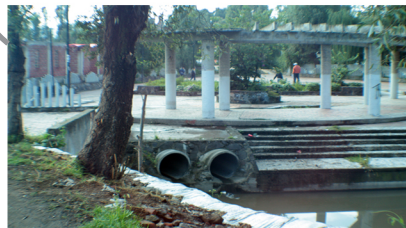
Desagüe de drenaje al canal.
