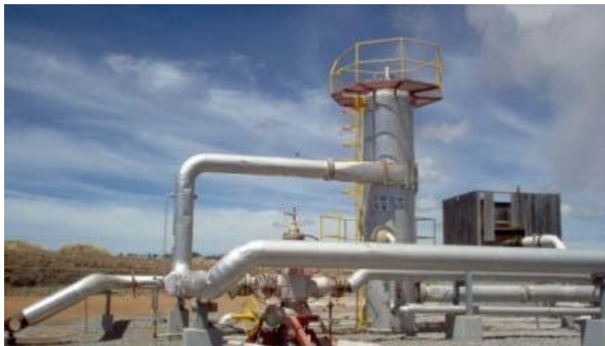
Figura 2.8 Central geotermoelectrica Los Humeros. [2]
