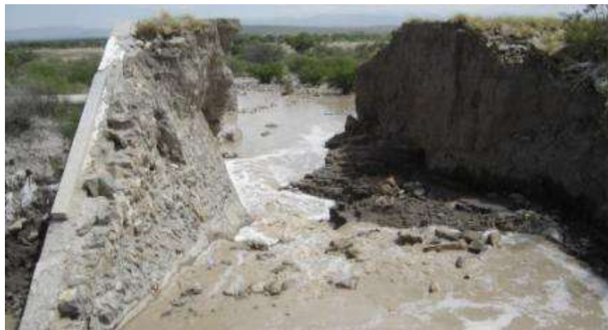
Fig. 1-24 Presa Piedra Blanca, Coah. Segunda falla por tubificación, 2007. Marengo (2011).
