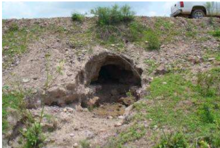
Fig. 1-25 Falla de bordo por tubificación. Ramírez-Reynaga 2008.
