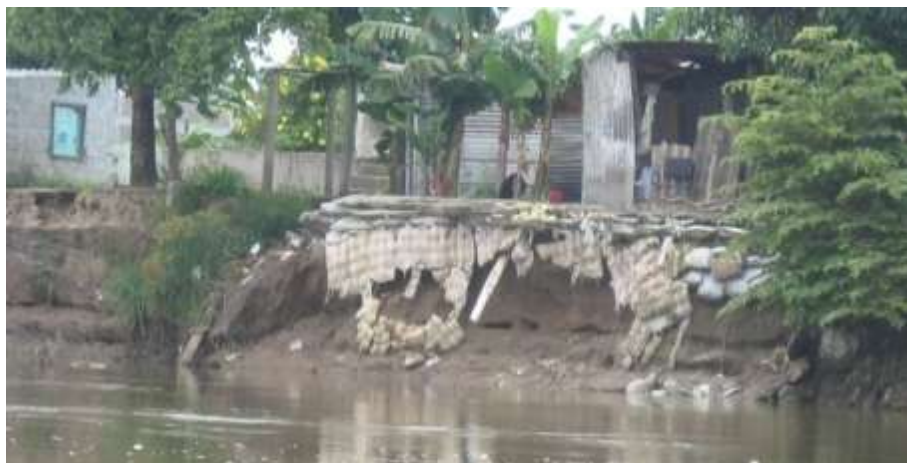
Fig. 1-22 Evidencias de falla por tubificación en bordos marginales del río Carrizal.
