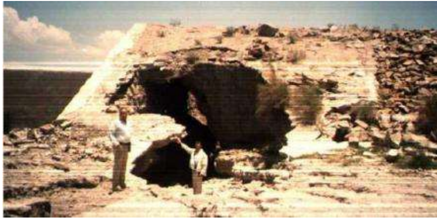
Fig. 1-23 Presa Piedra Blanca, Coah. Primera falla por tubificación, 1999. Marengo (2011).
