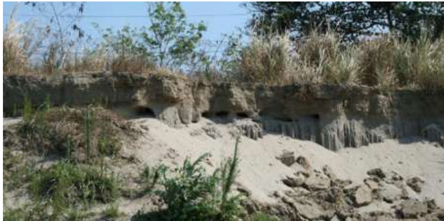
Fig. 1-21 Evidencias de tubificación en márgenes del río Carrizal.
