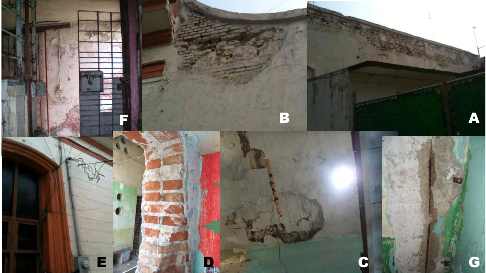
A) Faltantes B) Desprendimientos C) Humedad D) Oquedades E) Instalación Inadecuada F) Intervención Con Cemento En Resanes G) Perdida Parcial De Aplanado
