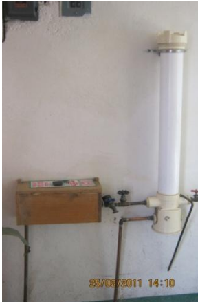
25/febrero/2011 Puente Blanco, Iztapalapa, DF. Filtro a la entrada de la toma de agua
