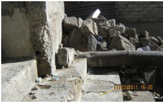
17/febrero/2011 Tlalpexco, GAM, DF. Tubos dentro de escaleras de la calle
