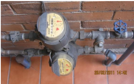
26/febrero/2011 Pedregal del Maurel, Coyoacán, DF. Medidores de UH
