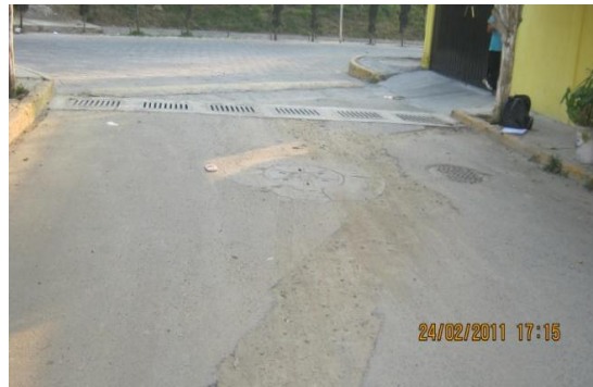
24/febrero/2011 Barrio Candelaria Ticomán, GAM, DF. Fugas: contaminación y desperdicio
