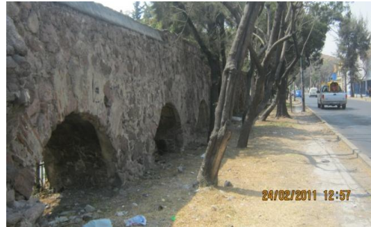
24/febrero/2011 Barrio Candelaria Ticomán, GAM, DF. Avenida Acueducto: lugar de eternas fugas
