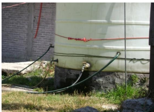
14/febrero/2011 El Santuario, Iztapalpa, DF. Conexiones domésticas, con manguera
