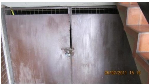
26/febrero/2011 Pedregal del Maurel, Coyoacán, DF. Cisterna resguardada por edificio
