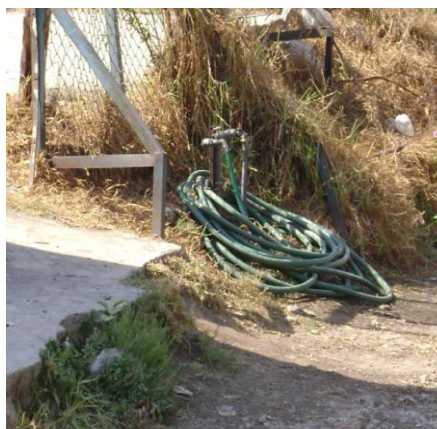
14/febrero/2011 El Santuario, Iztapalpa, DF. Toma para varias conexiones domésticas
