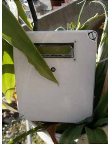
Figura 6.38.- Módulo de humedad instalado
