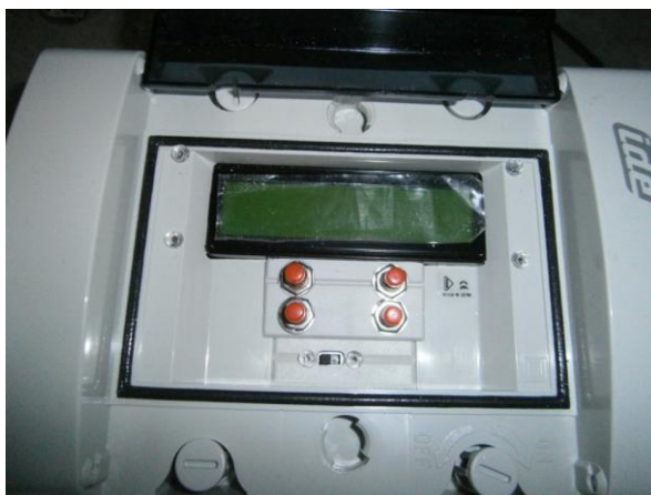
Figura 6.36.- Módulo de control instalado.
