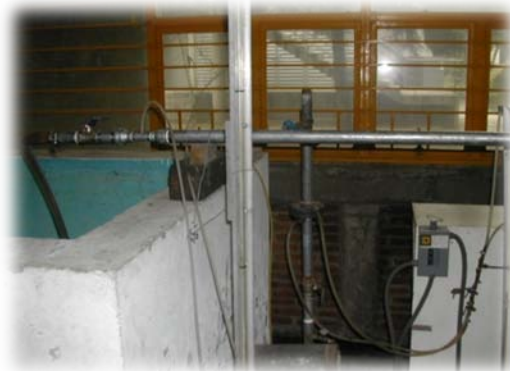
Figura 58.- Tubo Venturi y Manómetro Diferencial de Hg
