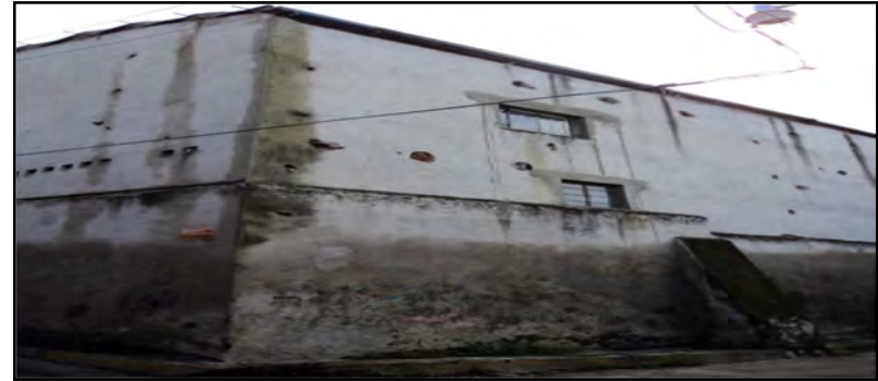
IMAGEN 5.20 VIVIENDA DETERIORADA POR HUMEDAD Y LLUVIA ALA ORILLA DEL RIO CHALMA
