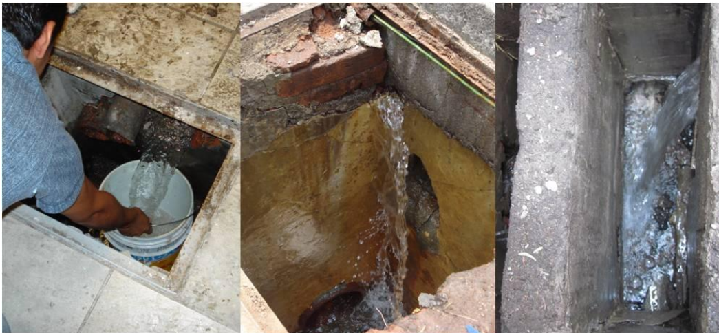
Figura 15. Fugas de agua potable en Ciudad Universitaria. Fuente: Archivos del área de Balance Hidráulico de PUMAGUA.
