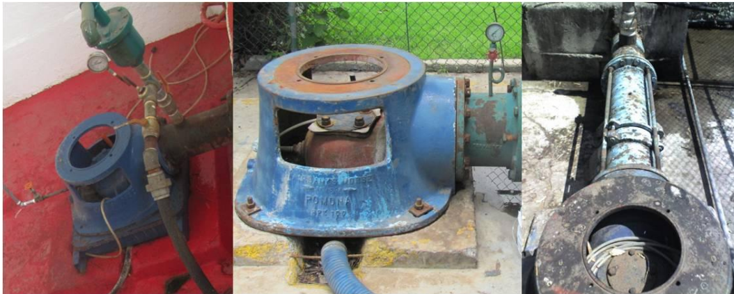
Figura 8. a) Pozo de la Facultad de Química, b) Pozo de Vivero Alto y c) Pozo Multifamiliar. Fuente: Archivos del área de Balance Hidráulico de PUMAGUA.
