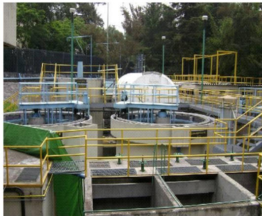
Figura 9. Planta de Tratamiento de Aguas Residuales en Cerro del Agua, Ciudad Universitaria. Fuente: Archivos del área de Balance Hidráulico de PUMAGUA.
