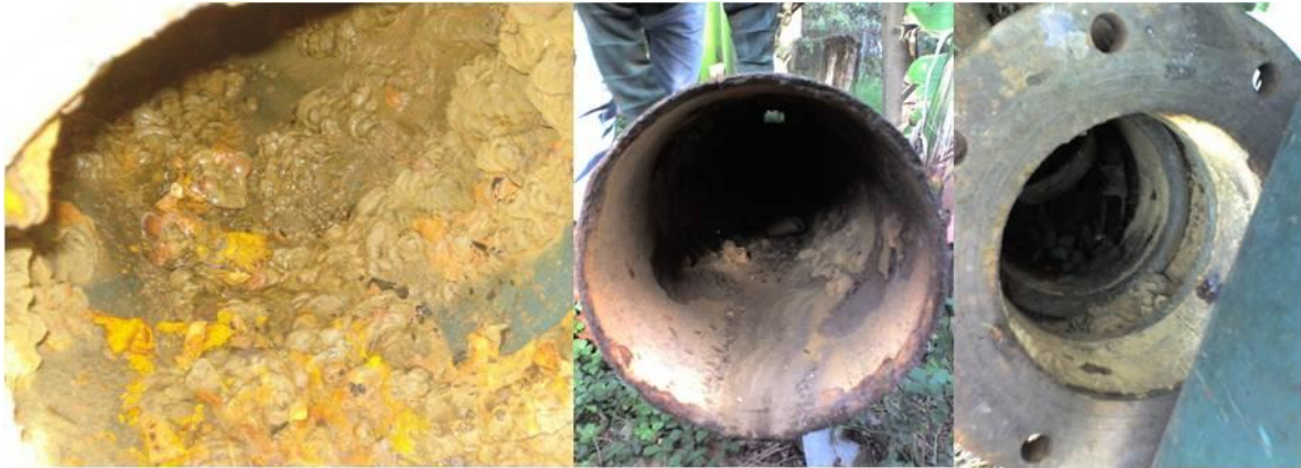
Figura 15. Incrustaciones en la tubería de potable de Ciudad Universitaria debido a la salinidad del acuífero.
