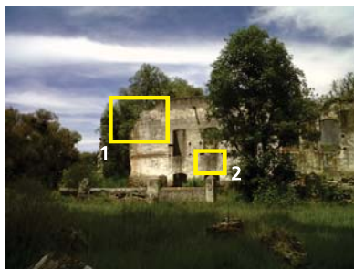
1 Derrumbe parcial 2 Erosión del material
