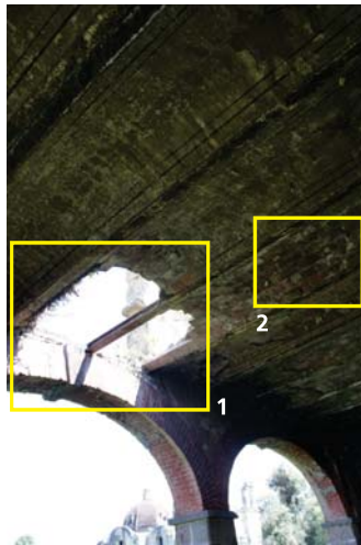
1 Derrumbe parcial 2 Erosión superficial
