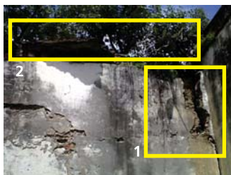
1 Grieta vertical 2 Corrosión del material
