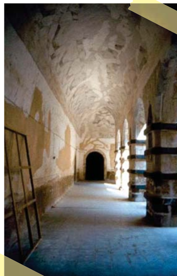
Falla por agrietamiento en la superficie de la bóveda.
