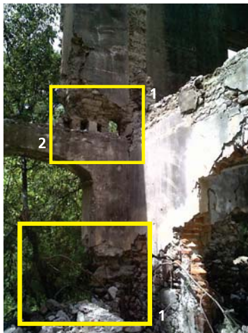
1 Corrosión superficial 2 Desplome
