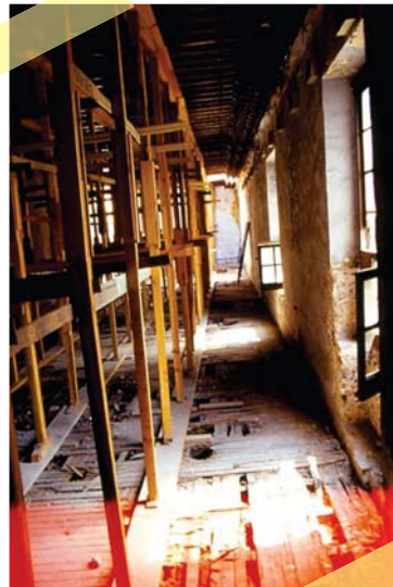
Deterioro en entresijo por flexión, cortante o torsión en vigas de madera.
