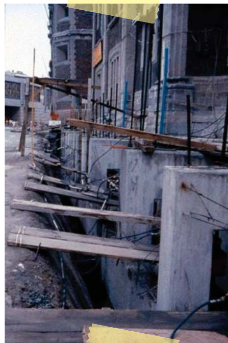
Deterioro en cimentación, debido a la deformación del suelo.
