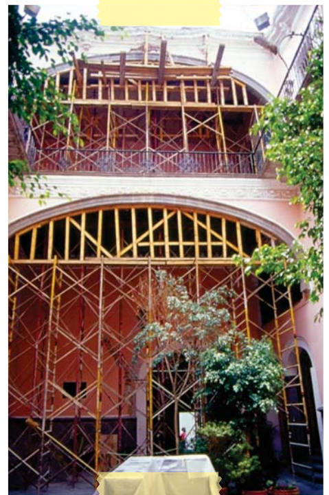
Deterioro de arcos por fracturas.
