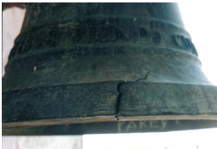
Figura A5. Detalle de la fractura de la campana A. Ubicación: 2do piso, lado oeste del campanario.
